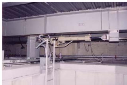
Figura 1.3: Actuador bajo helipuerto. Torre Applause, Osaka, Japón.
