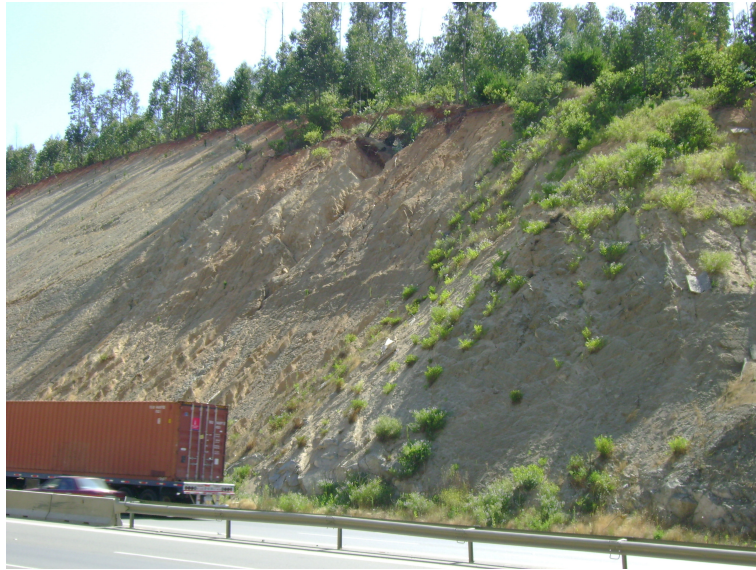
Fig 39 “Km 100.800 falla en este kilometraje”
