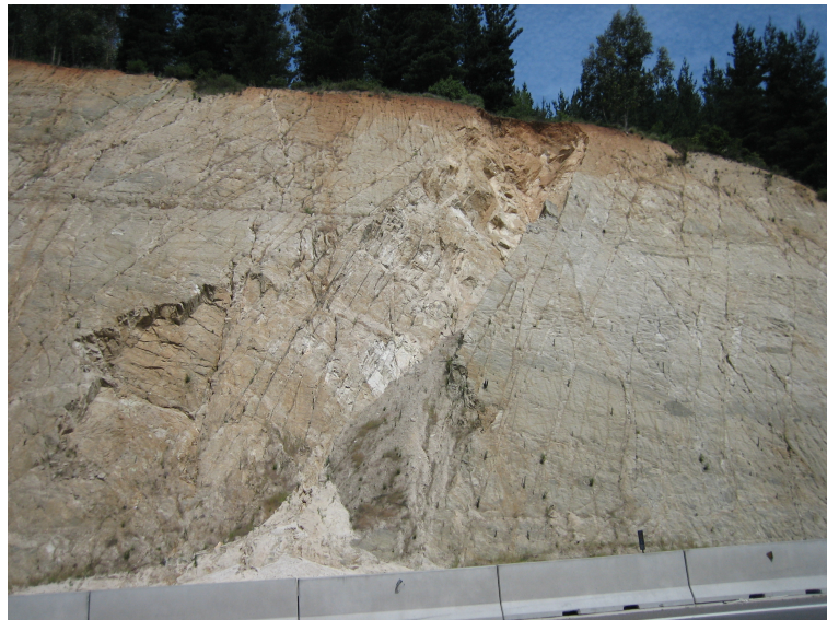
Fig 38 “Km 100.800 detalle de las diaclasas en el talud”
