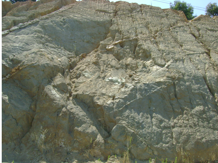
Fig 37 “Km 98.300 detalle se las diaclasas en el talud”
