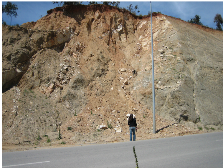
Fig 36 “Km 98.300 detalle de una de las fallas en este kilometraje”
