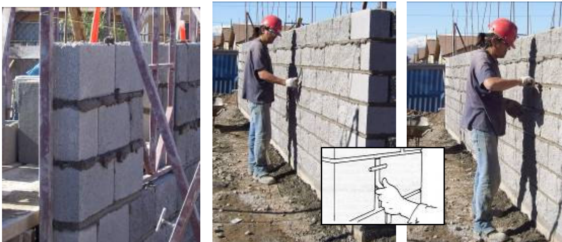
Figura N° 16: Ejecución de canterías cuando el mortero de juntas aun no esta endurecido.
