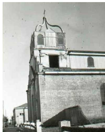
Daños. (Fuente: www.miguelgonzalez.cl/fotos )
