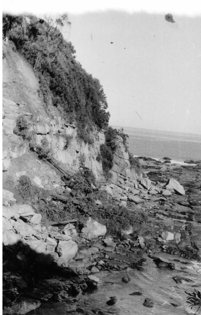
Derrumbe en Parque Lota. (foto cortesía E. Kausel)
