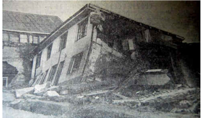
Edificio da ñado ubicado en la calle García Reyes de Valdivia. (Fuente: El Mercurio)
