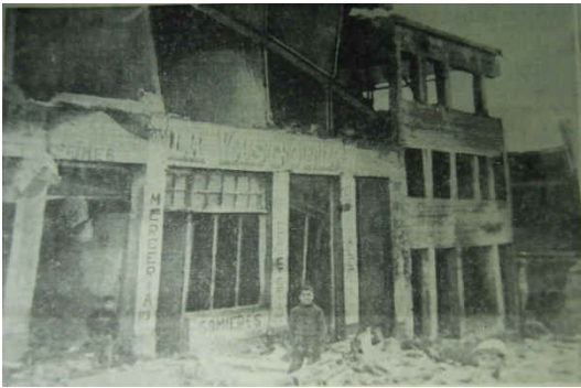
Las estructuras mal diseñadas produjeron en las zonas afectadas por los terremotos daños similares a los que aquí se observan. (Fuente: El Mercurio)
