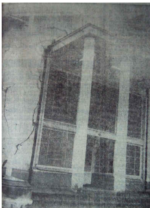
Figura 4.54. Daños en el entonces moderno hospital de Schwager. (Fuente: El Mercurio)
