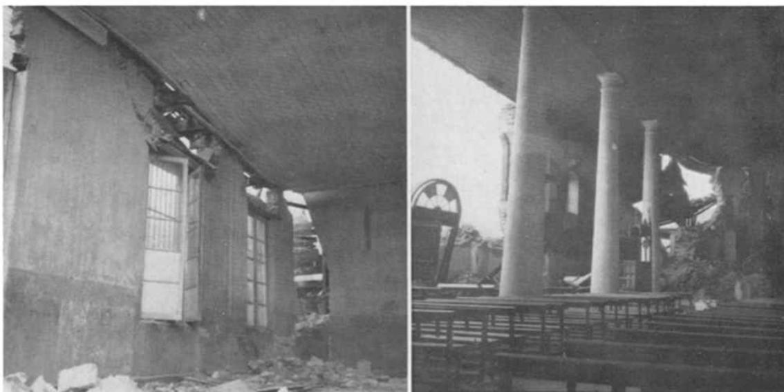
IZQUIERDA: Daño en el edificio de la Intendencia. Albañilería sin refuerzos. DERECHA: Daños en la iglesia de Lebu. Construcción de albañilería.
