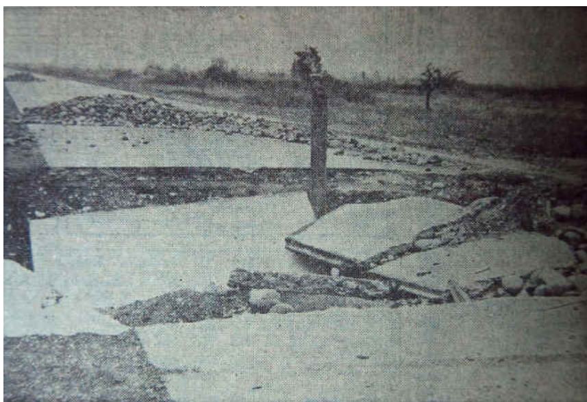
Figura 4.53. Destrucción de la Carretera Panamericana. a 23 kilómetros al norte de la ciudad de San Carlos. (Fuente: El Mercurio)
