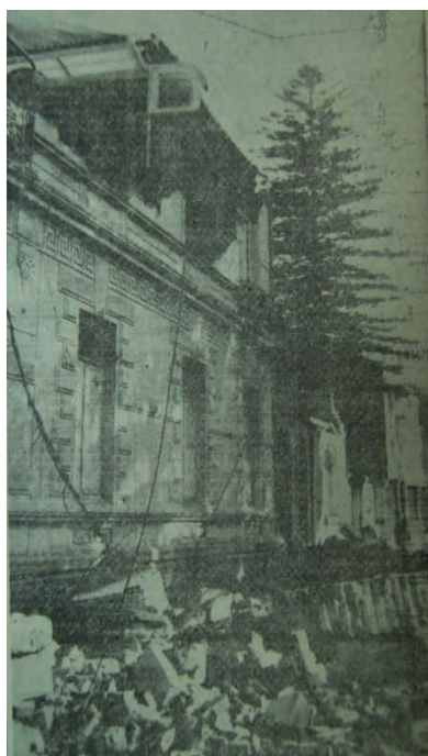
Figura 4.30. Daños en el Hospital Traumatológico de Concepción. (Fuente: La Unión)
