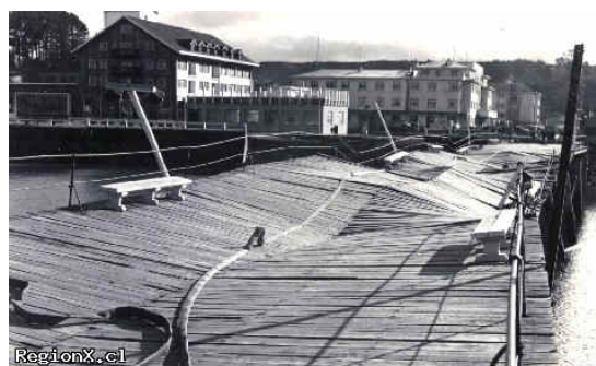
Vista de las deformaciones del muelle (Fuente: Internet)
