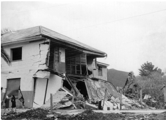
Figura 6.59. Daños en viviendas de Puerto Montt. (Fotos cortesía de E. Kausel)
