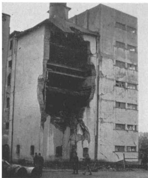
Figura 6.55. Daños en Compañía Cervecería (Steinbrugg y Flores, 1963).
