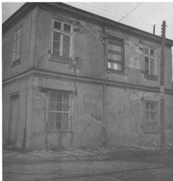
Figura 4.38. Daños de una vivienda de Lebu construida en albañilería. (Álvarez, 1963)
