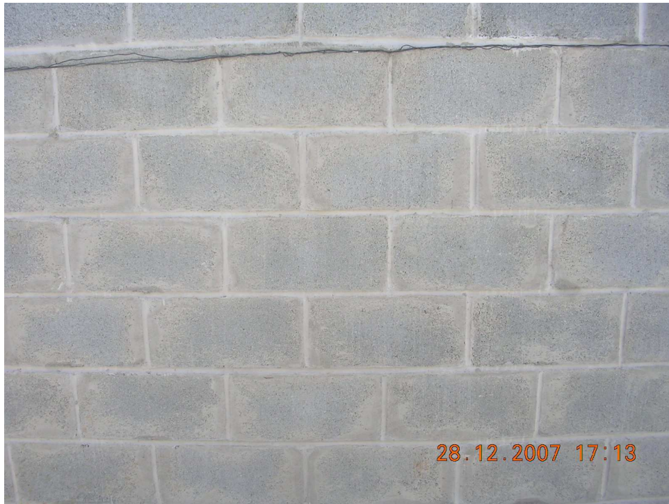
Fotografía 2.4: Muro 2 a 120 min de inicio de ensayo.
