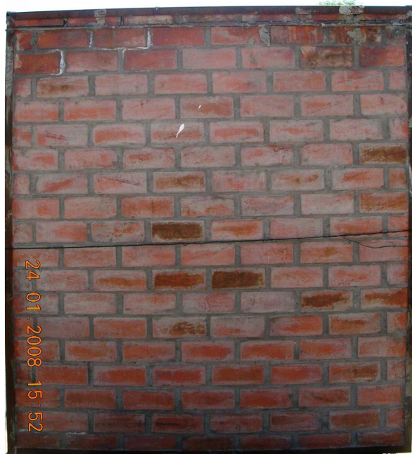
Fotografía 5.6: Muro 5 a 180 min de inicio de ensayo.
