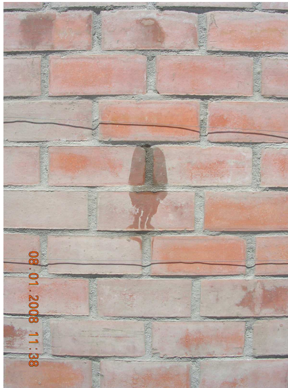
Fotografía 3.2: Muro 3 a 60 min de inicio de ensayo.
