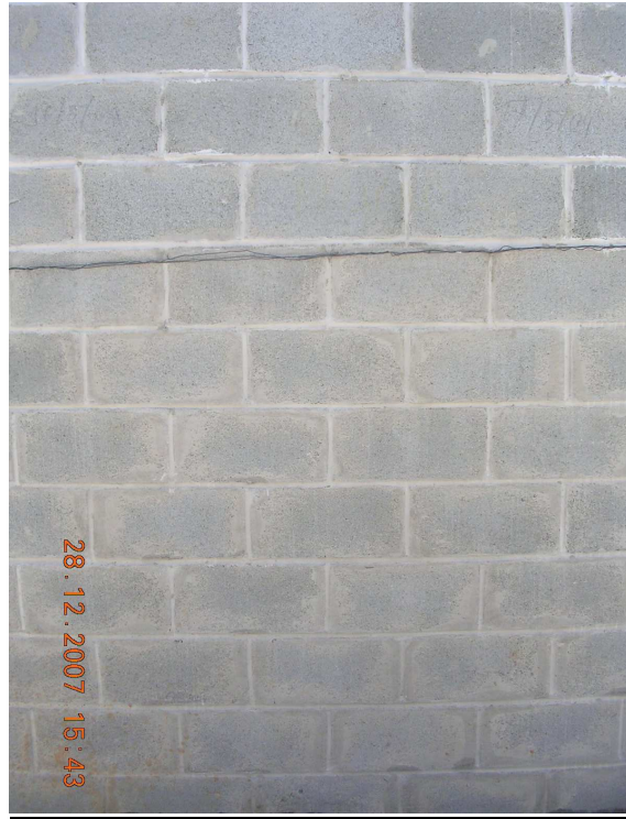
Fotografía 2.1: Muro 2 a 30 min de inicio de ensayo.
