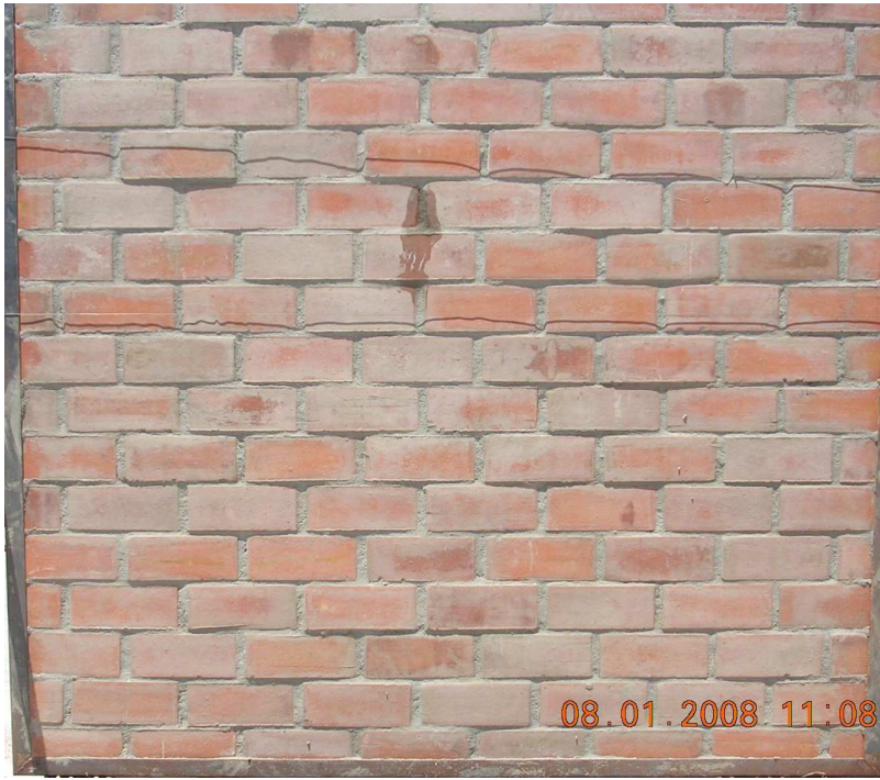
Fotografía 3.1: Muro 3 a 30 min de inicio de ensayo.
