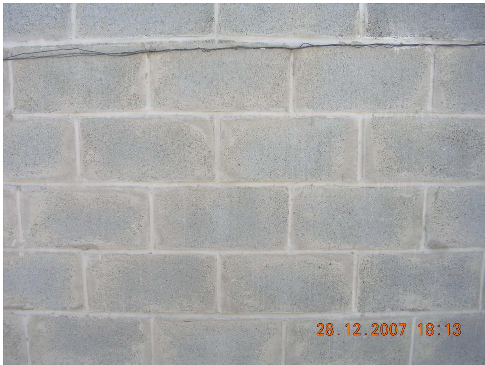
Fotografía 2.6: Muro 2 a 180 min de inicio de ensayo.
