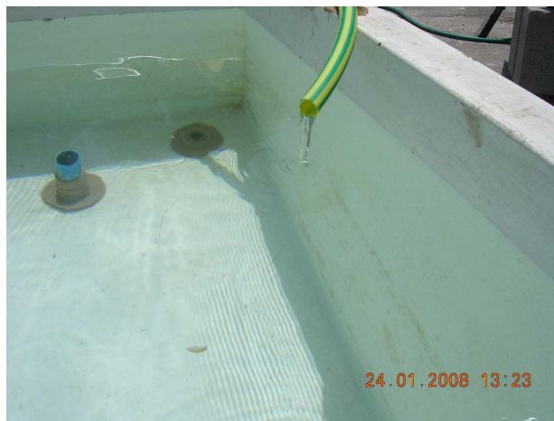
Fig.4.8 – Manguera que recarga el estanque
