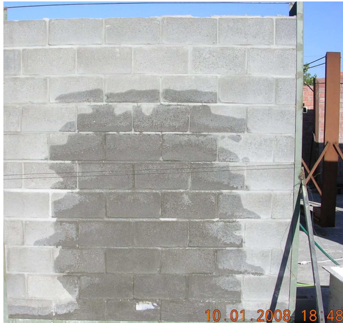
Fotografía 4.6: Muro 4 a 180 min de inicio de ensayo.
