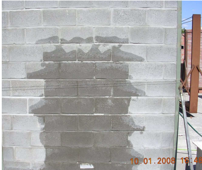
Fotografía 4.2: Muro 4 a 60 min de inicio de ensayo.
