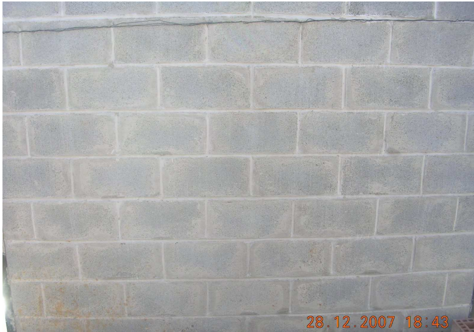
Fotografía 2.7: Muro 2 a 210 min de inicio de ensayo.
