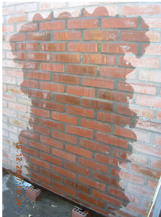
Fotografía 1.6: Muro 1 a 180 min de inicio de ensayo.
