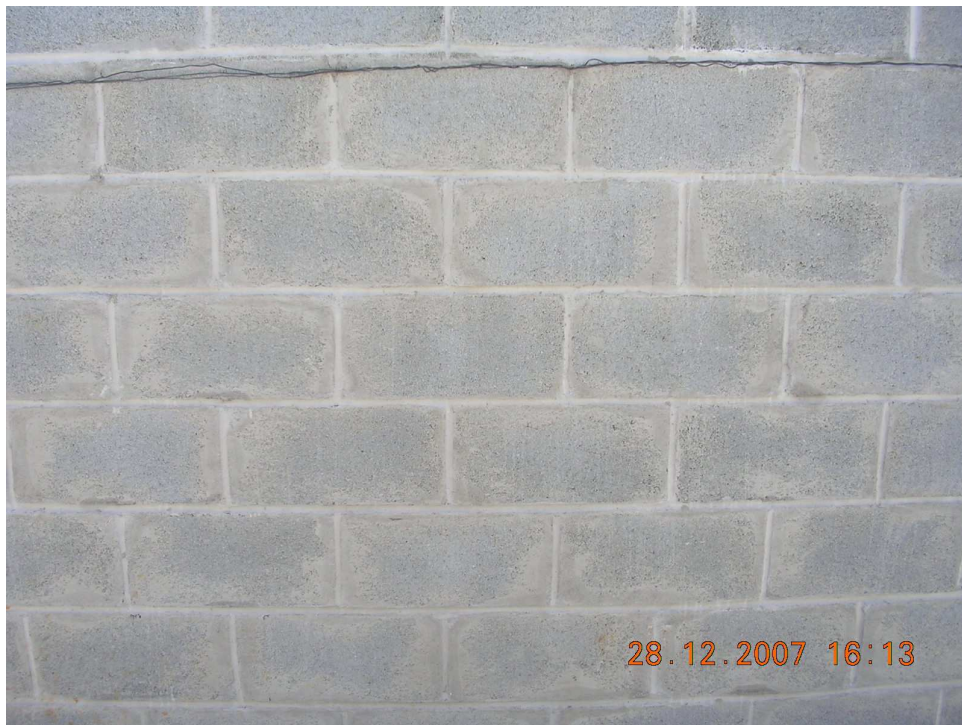
Fotografía 2.2: Muro 2 a 60 min de inicio de ensayo.
