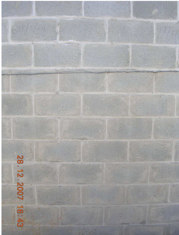
Fotografía 2.3: Muro 2 a 90 min de inicio de ensayo.
