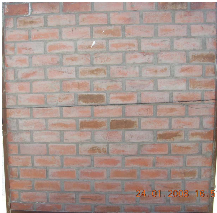
Fig. 6.2.5 Cara opuesta a la cámara en Muro 5 luego de 4 h de ensayo.
