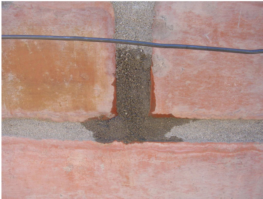
Fig. 6.2.1 Primer indicio de humedad en Muro 1
