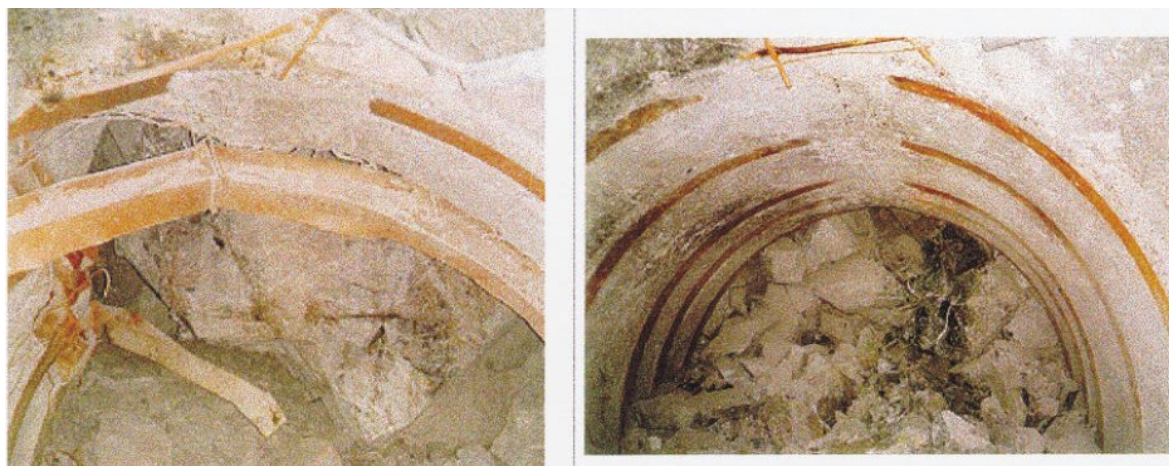
Figura 2-8: Daño típico en puntos de extracción: caso convencional (izquierda) y previo (Rojas et al, 2000)
