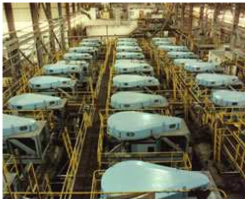
Figura 6. Visión general de bancos de celdas de flotación
