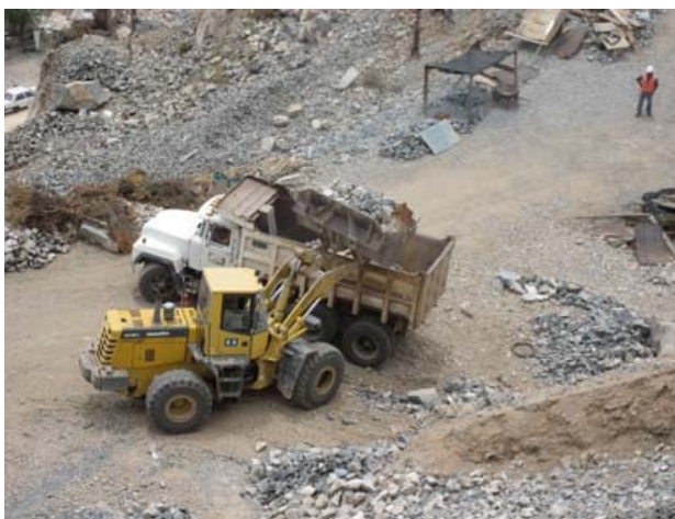
Máquina retroexcavadora cargando un camión con desmontes, que serán transportarlos a la planta chancadora y convertirlos en gravilla o arena (2008).
