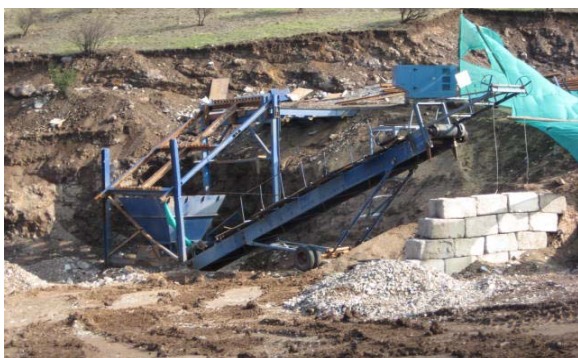
Desarme de planta chancadora de la empresa Áridos Quintay S.A. en el cerro La Pedregosa (2008).
