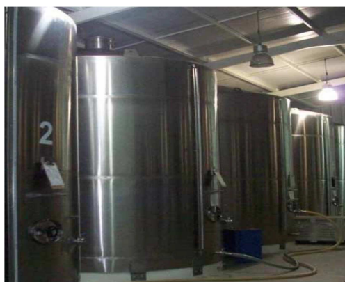
Figura 4.1 Estanques apoyados sobre el suelo
