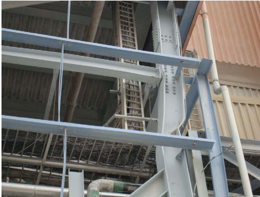
Figura 2.8: Choque entre Estructuras Vecinas (Montecinos, 2010)
