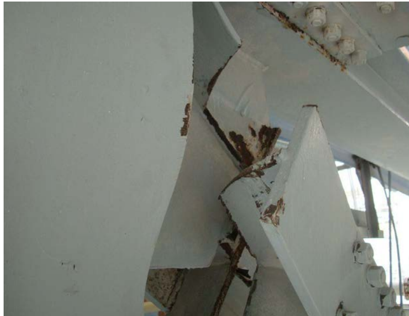
Figura 2.6: Falla Conexión Columna-Diagonal (Montecinos, 2010)
