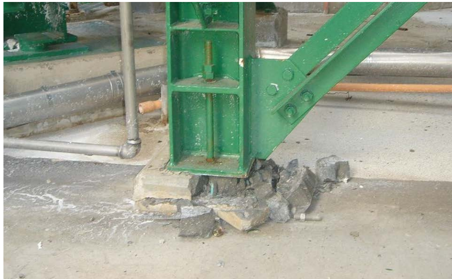
Figura 2.11: Pedestal Fracturado por Esfuerzos de Corte (Montecinos, 2010)
