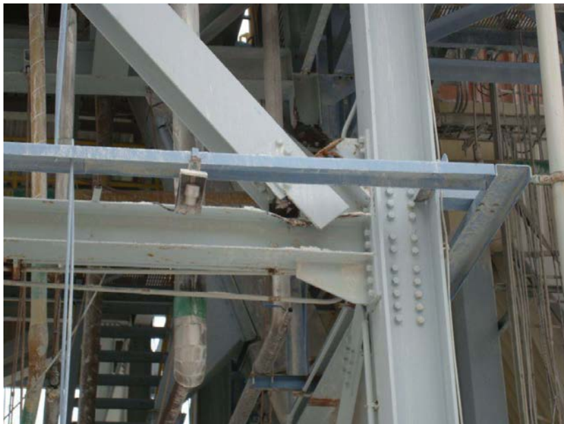
Figura 2.7: Falla Conexión Columna-Diagonal (Montecinos, 2010)
