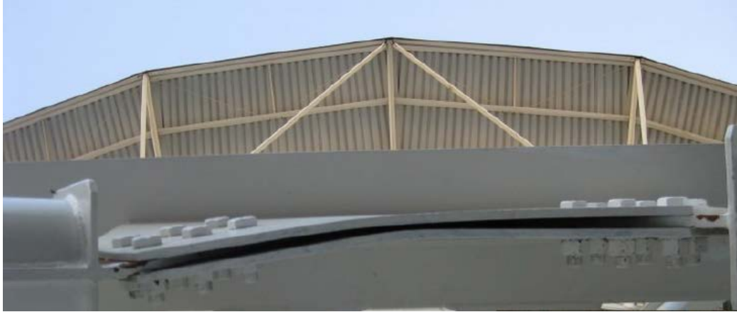
Figura 2.4: Pandeo en placa Gusset (Montecinos, 2010)
