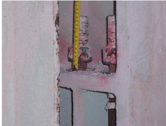
Figura 2.10: Fluencia en Pernos de Anclaje Columna (Montecinos, 2010)
