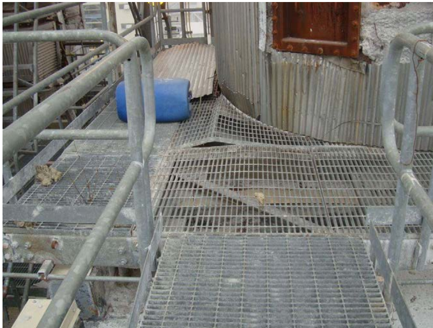
Figura 2.9: Choque entre Equipo y Parrillas Perimetrales (Montecinos, 2010)
