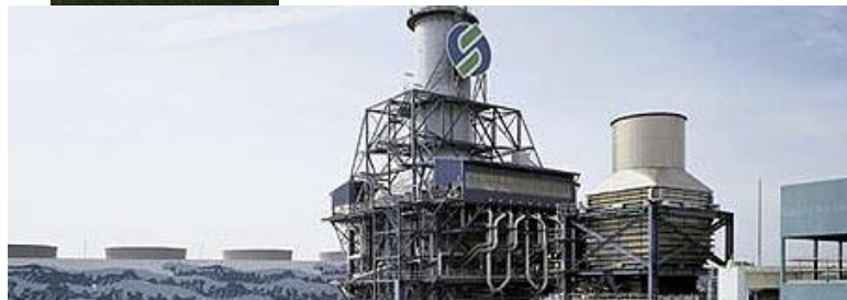
Figura 5.1: Central térmica de ciclo combinado San Isidro [51] [52].
