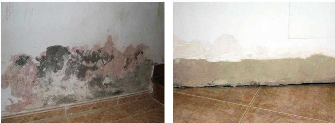
Figura 2.3 Humedad por capilaridad.
