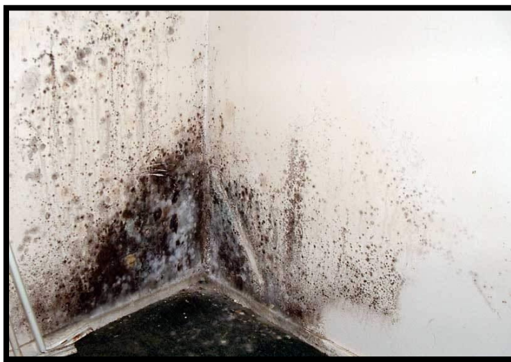
Figura 3.6 Hongos en paredes producto de la humedad.
