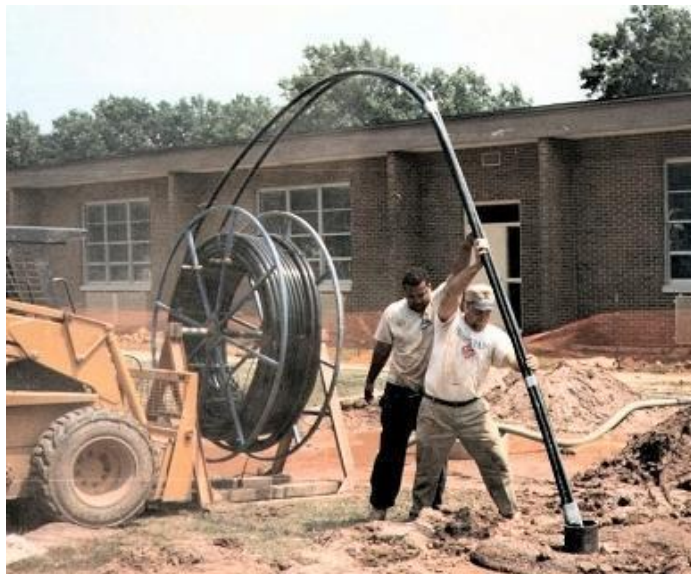
Figura 5.13: Proceso de instalación del tubo U desde el carrete al pozo, el encamisado temporal previene el derrumbe del pozo.
