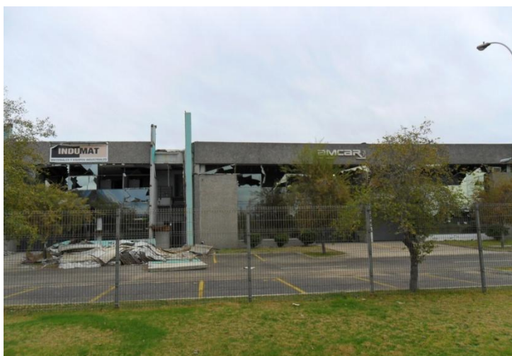
Foto 4: Industria con daño máximo. Estructura totalmente colapsada y doblada. Coincide con la zona de mayor depósito de finos. Medida Nakamura c5
