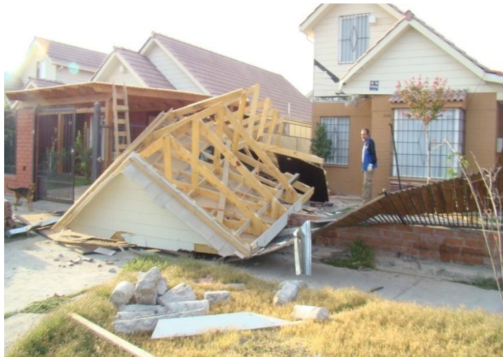
Foto 33: Estructura de ladrillo y madera desplomada en Larapinta.
