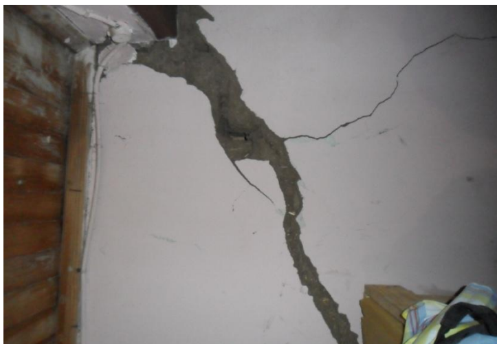
Foto 16: Daño en paredes, al interior de casa de adobe en Lampa.
