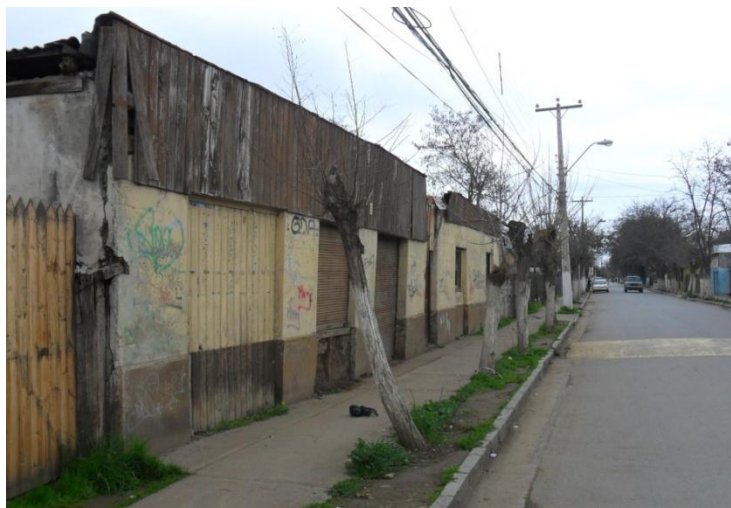
Foto 14: Vivienda de adobe abandonada post terremoto en Lampa.
