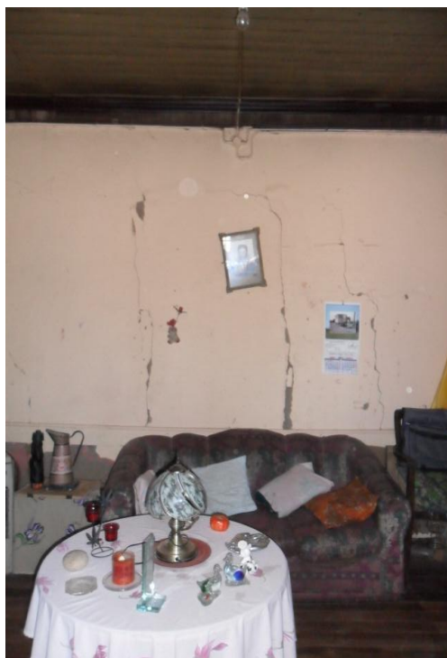
Foto 26: Casa de adobe destruida por dentro en Batuco.
