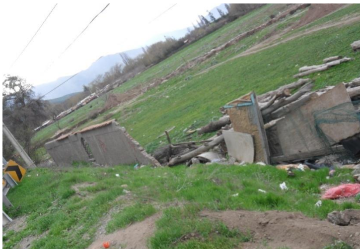
Foto 20: Daño en pared de ladrillo en El Noviciado.
