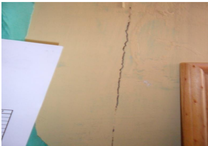
Foto 23: Grietas en colegio de Ladrillo en Santa Sara, al este de Batuco
