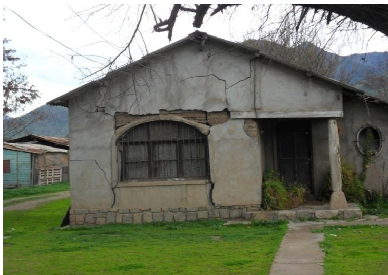
Foto 18: Fachada de casa de adobe post terremoto. Lampa.
