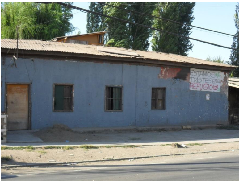
Foto 31: Casa de adobe totalmente dañada por terremoto en Estación Colina.
