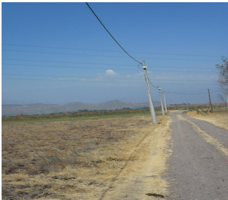
Foto 8: postes de tendido eléctrico inclinados sobre depósitos lagunares.
