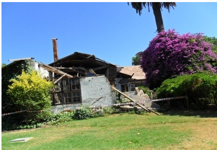
Foto 21: Fundo Casas del Rey totalmente destruida.
