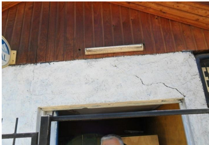
Foto 25: Grietas típicas encontradas en construcciones de ladrillo en Batuco
