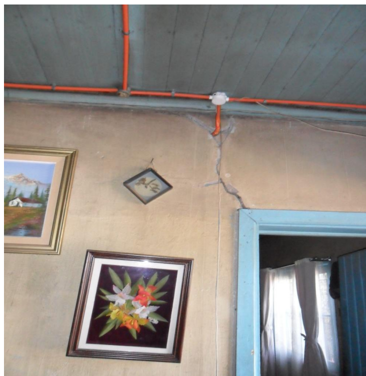
Foto 32: Interior de segunda casa de adobe destruida en Estación Colina
