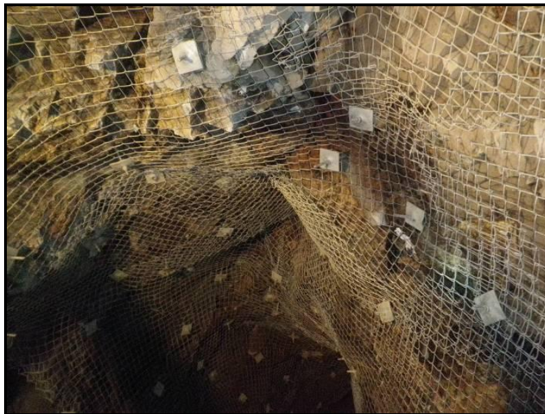
Figura 57: Fotografía de desprendimiento de bloques en el techo (Pk 5354).
