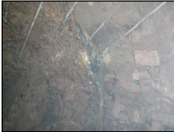
Figura 58: Fotografía de falla de dip/dipdir: 75/50 y relleno de arcilla y salvanda en la frente del Pk 5352.
