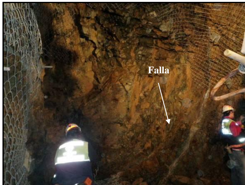
Figura 59: Fotografía de falla de dip/dipdir: 70/45 en caja derecha en el Pk 5343.
