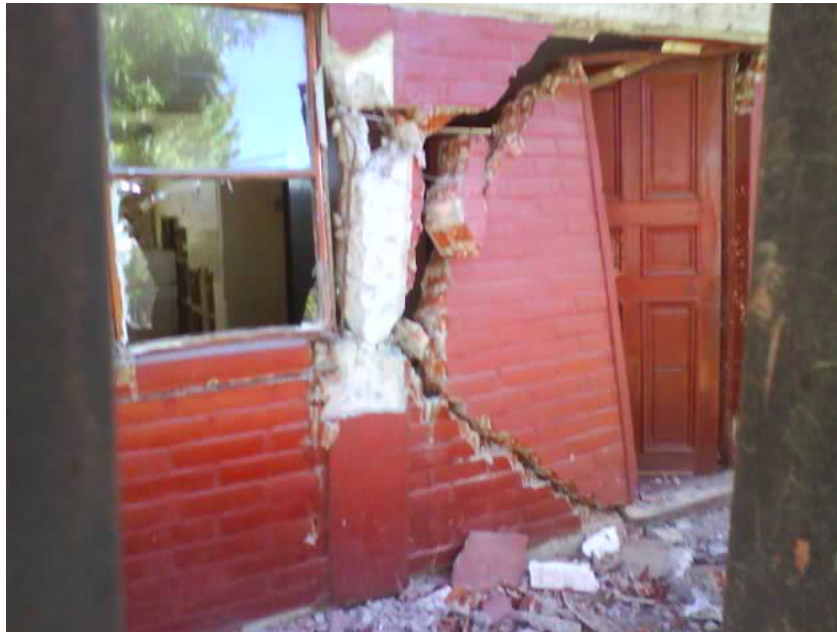
Figura 3.14: Daños en el paño de albañilería vecino a una abertura de puerta no reforzada (Pinto, 2011)
