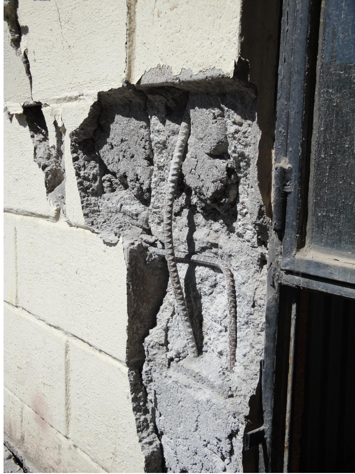
Figura 3.3: Falla por pandeo de barra de refuerzo vertical (Astroza, 2010)
