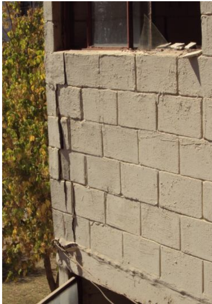
Figura 3.8: Daños en encuentro de muros (Núñez, 2010)
