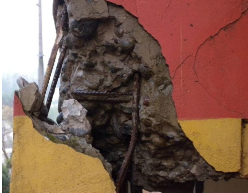
Figura 3.18: Daño en el nudo de encuentro de un pilar y de una cadena (Astroza et al. , 2010b)
