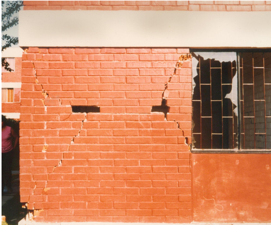
Figura 3.6: Daño en un muro sin barras de refuerzo horizontal en el paño de albañilería (Astroza, 1985)
