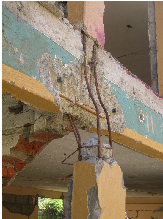
Figura 3.19: Daño en el nudo de encuentro de un pilar y de una cadena (Astroza, 2010)
