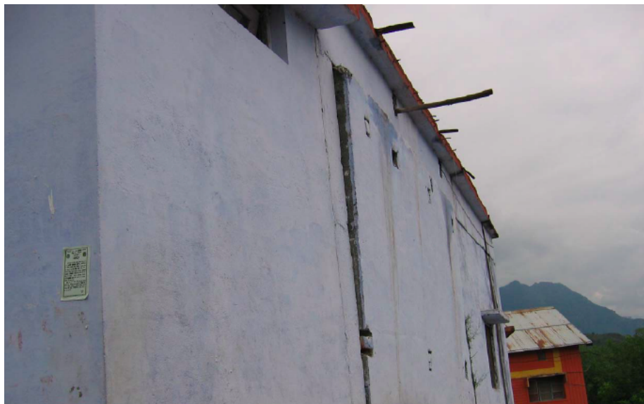
Figura 3.11: Inicio del vaciamiento por falla en la unión entre el paño de albañilería y el pilar de confinamiento (BuildChange, 2006)
