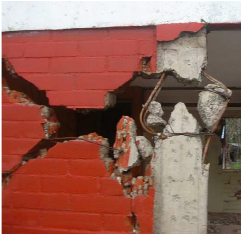
Figura 3.23: Daño en un pilar de confinamiento por falta de estribos (Astroza et al. , 2010b)
