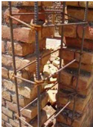
Figura 2.68: Alternancia en la colocación de los ganchos de los estribos en obra
