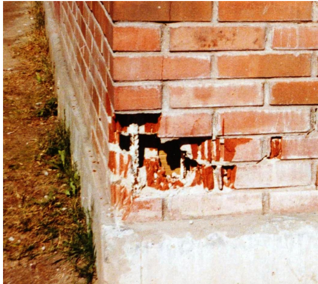
Figura 3.2: Diámetro excesivo de la barra de refuerzo vertical (Astroza, 1985)
