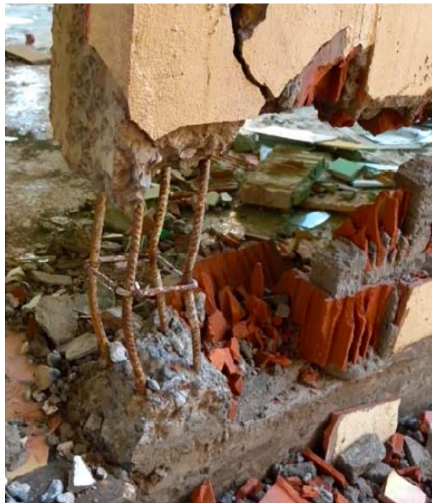
Figura 3.16: Daño severo en un pilar de confinamiento de dimensiones reducidas (Astroza et al. , 2010b)
