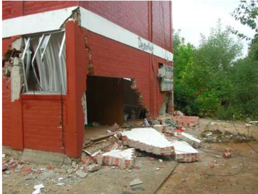
Figura 3.10: Vaciamiento por falla de la unión entre el paño de albañilería y el pilar de confinamiento (Astroza et al. , 2010a)
