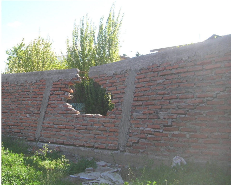
Figura 3.21: Daño en el empalme de barras longitudinales de una cadena de confinamiento (Astroza, 2010)
