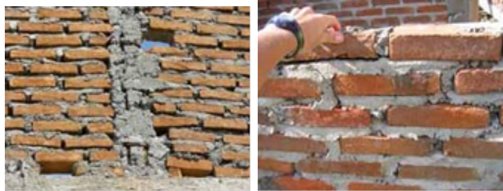
Figura 2.64: Junta de mortero gruesas y mal ejecutadas (Hausler, 2008)
