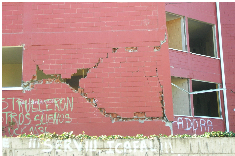
Figura 3.5: Daño en un muro con barras de refuerzo mal distribuidas en el interior del paño de albañilería (Astroza, 2010)
