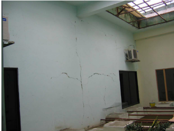
Figura 3.12: Inicio del agrietamiento en la unión entre el paño de albañilería y el pilar de confinamiento (BuildChange, 2006)
