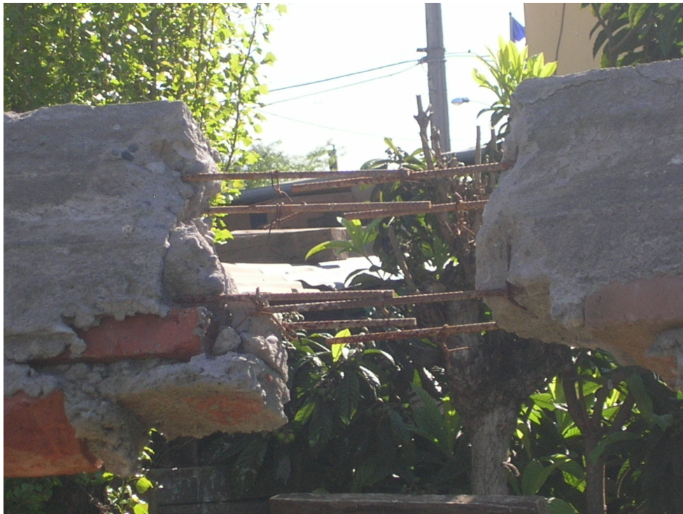
Figura 3.20: Daño en el empalme de barras longitudinales de una cadena de confinamiento (Astroza, 2010)
