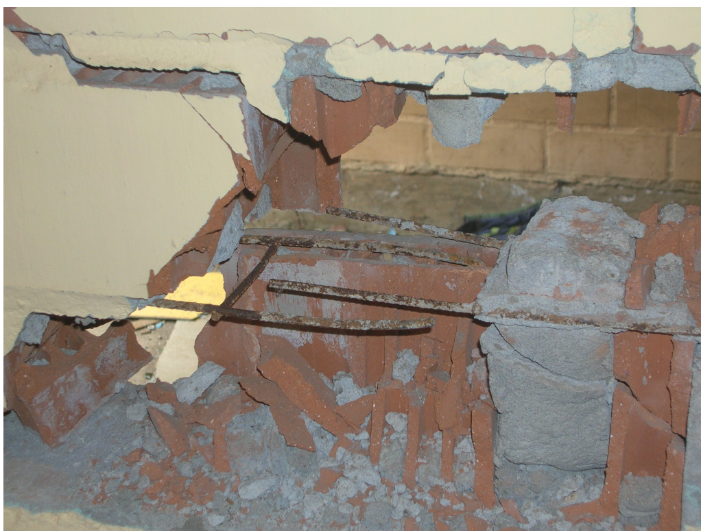
Figura 3.1: Falla en el empalme por traslape de las barras de refuerzo horizontal (Astroza, 2010)
