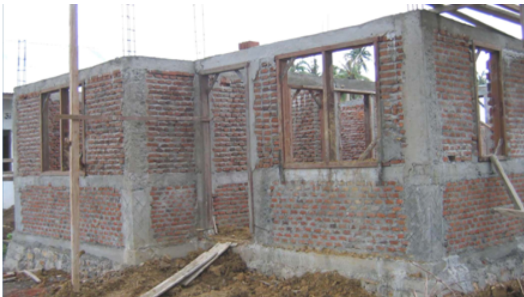
Figura 2.37: Aberturas de ventanas no reforzadas en una construcción en ejecución (BuildChange, 2006)
