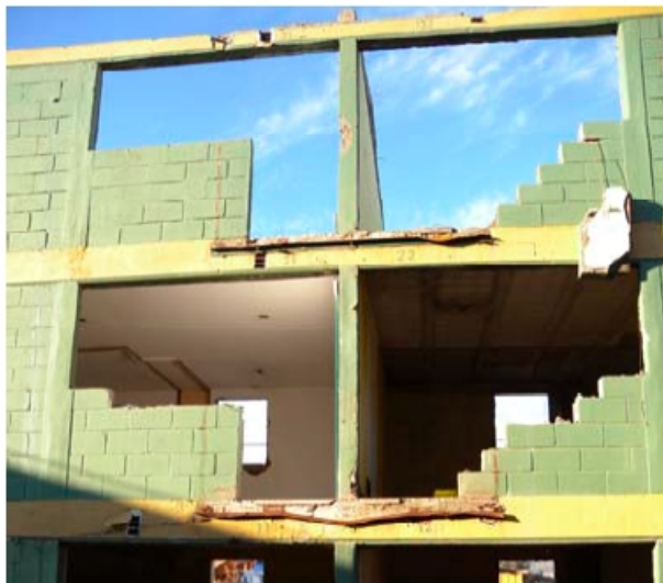
Figura 3.13: Daños en zona de aberturas (Astroza et al. , 2010b)
