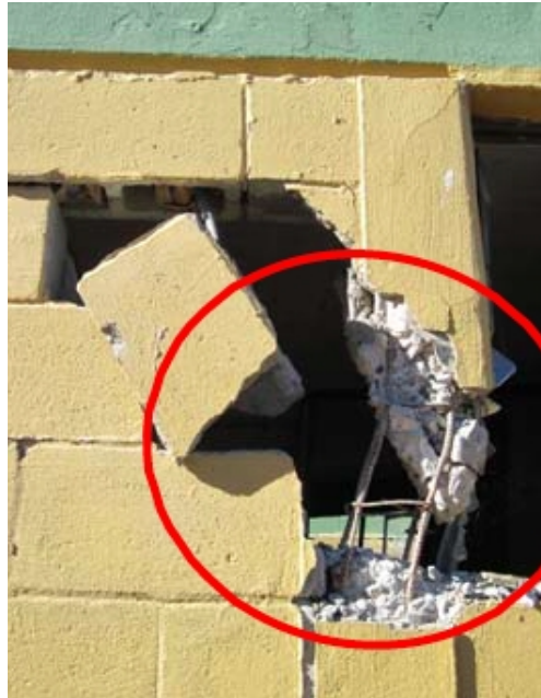
Figura 3.15: Daño severo en un pilar de confinamiento de dimensiones reducidas (Astroza et al. , 2010b)
