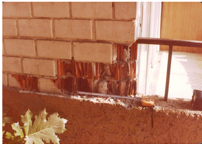
Figura 3.4: Falla por pandeo de barra de refuerzo vertical (Astroza, 1985)
