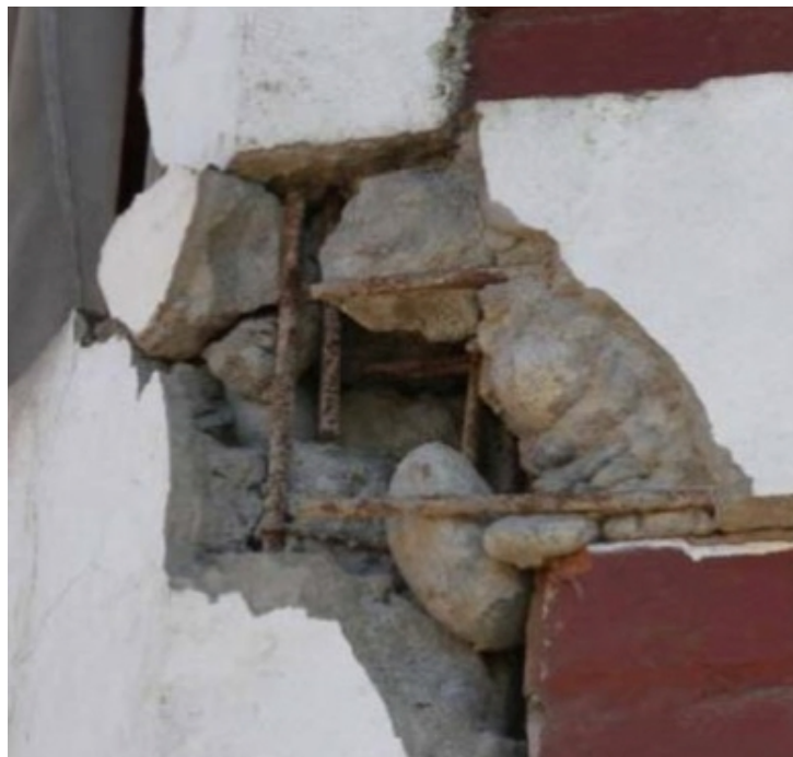
Figura 3.17: Daño en el nudo de encuentro de un pilar y de una cadena (Astroza et al. , 2010b)
