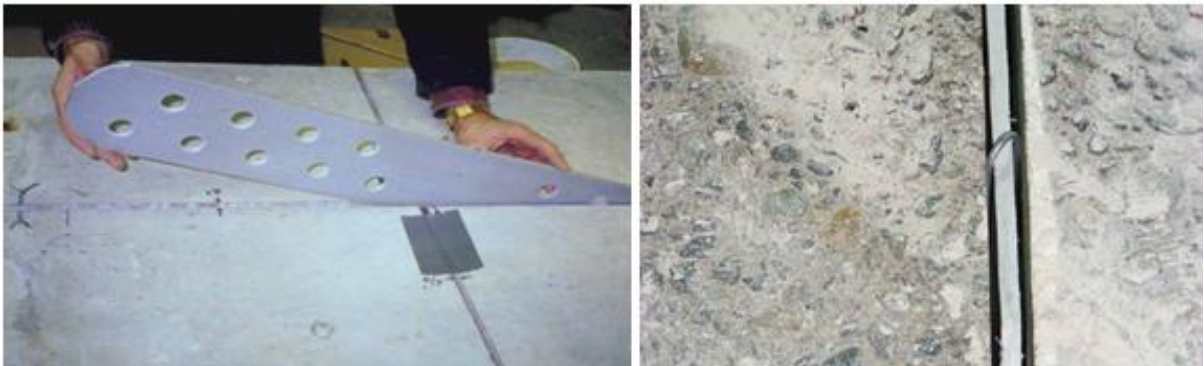
Figura II.22. A la izquierda: colocación placa. A la derecha: detalle clip separando placa de paredes.
