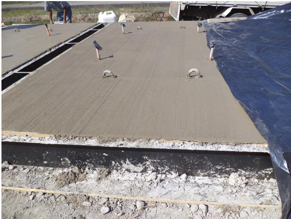
Figura V.8. Losa hormigonada y siendo cubierta con polietileno para su mejor curado. Posteriormente se le aplicó adicionalmente una membrana de curado.
