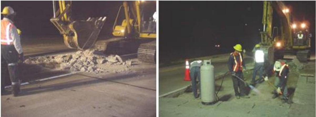
Figura II.18. A la izquierda: Remoción pavimento dañado. A la derecha: Limpieza de base y secado de pavimento.
