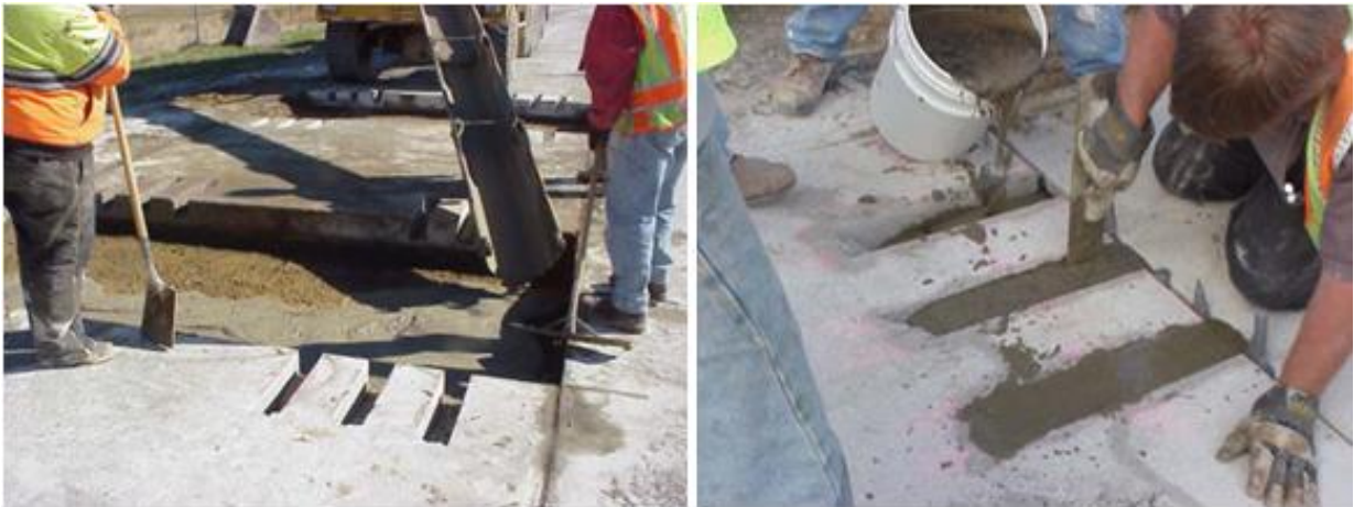
Figura II.11. A la izquierda: vaciado de relleno fluido. A la derecha: relleno de ranuras con grout.
