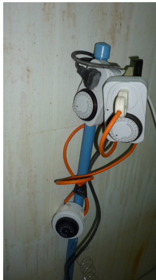
Figura 5.8. Termostato y Controles de Apagado y Encendido.
