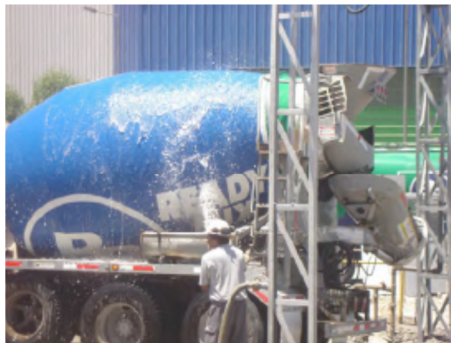
Figura 2.21. Enfriamiento de Camión Mezclador. (Fuente: Lagos. 2009)
