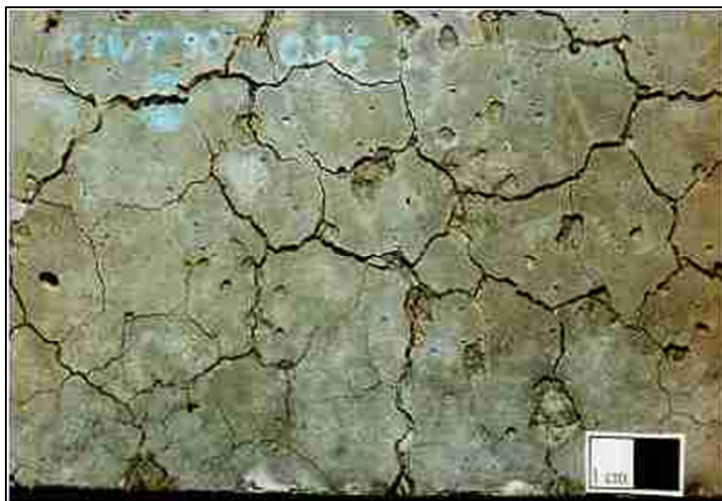
Figura 3.1. Estructura de hormigón dañada por efecto de la formación de etringita retrasada. (Fuente: http://www.uni-weimar.de ).
