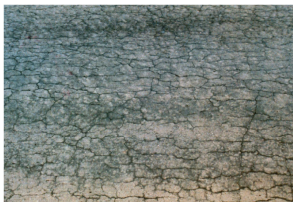
Figura 2.10. Superficie de Fundación Afectada por Formación Retardada de Etringita.
