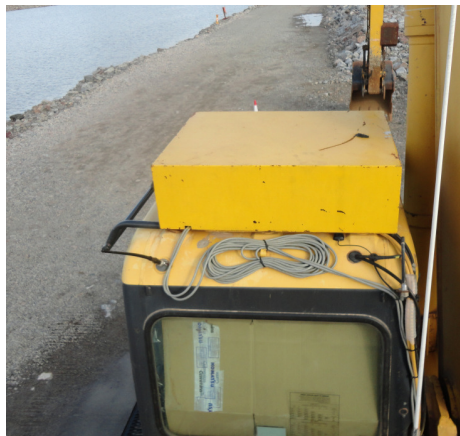
Imagen 3.25: Protección caja de distribución
