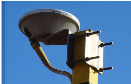
Imagen 2.17: Antena receptora (GPS)
