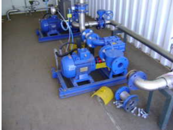
Figura 21. Sistema Booster implementado en la planta CCU Temuco.
