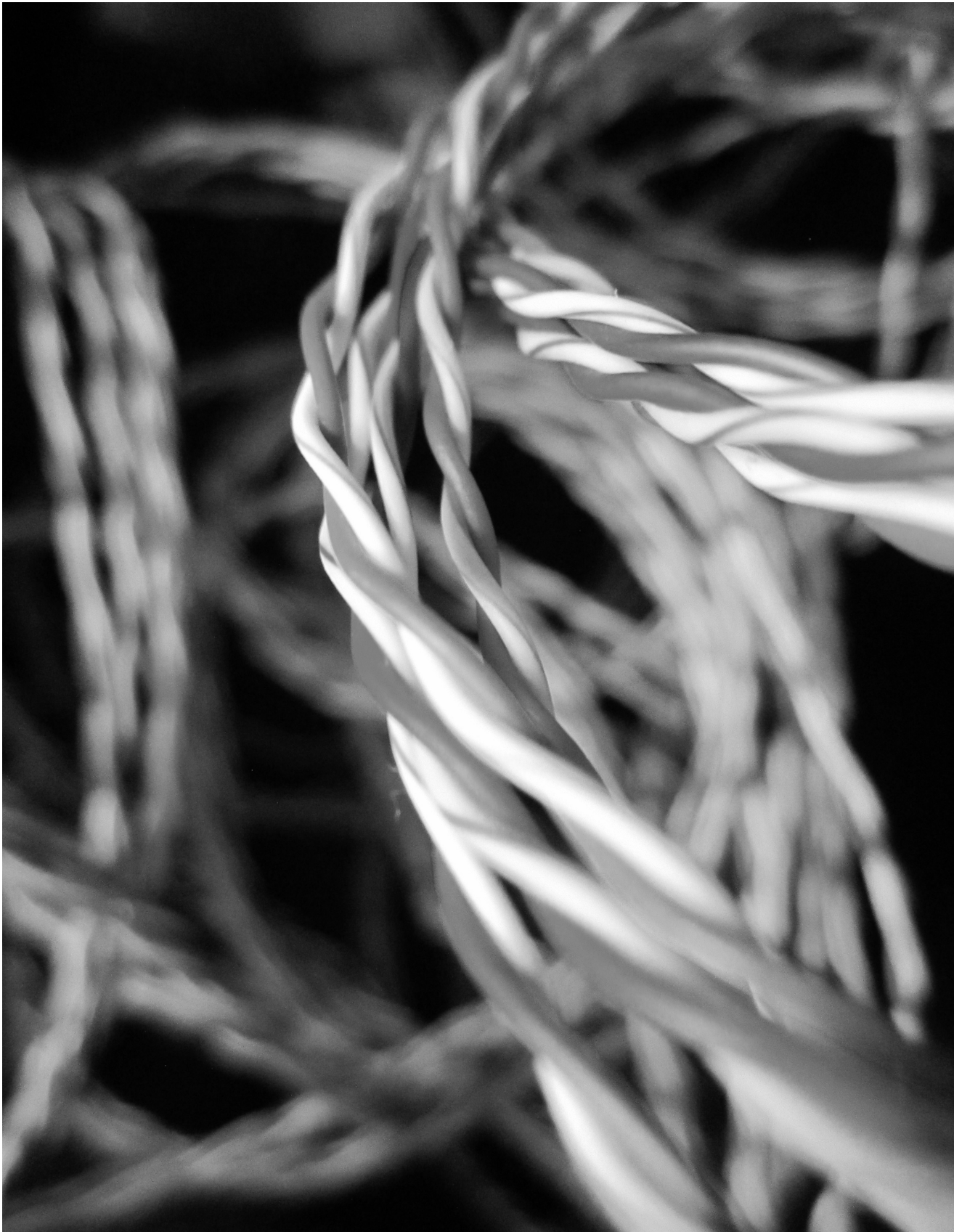
Cableado entre Controlador y Módulos
