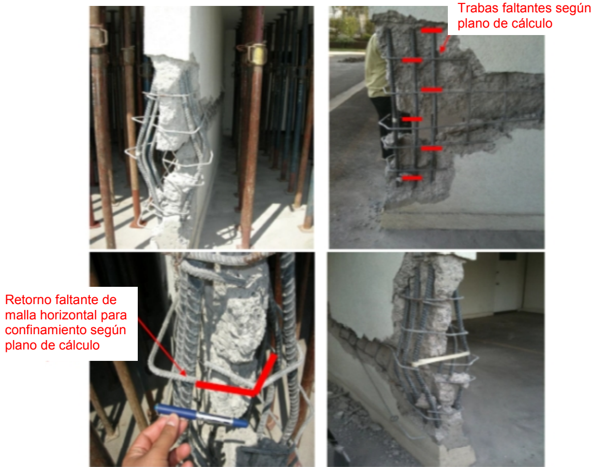
Figura 3.5 Daños por flexo-compresión en muro en eje 7, Edificio A.
