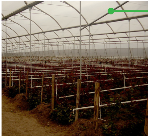
Tuberías que transportan el agua sobre los cultivos para elevar la temperatura del interior del invernadero. Imagen obtenida de la empresa Megatecnicos, especializados en la industria alimentaria y la utilización de sistemas de mantenimiento y montaje. www.megatecnicos.com
