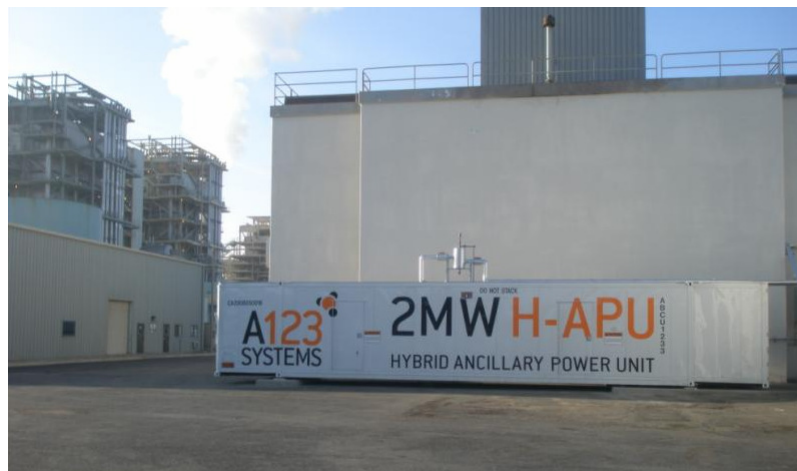
Figura 3.12: Sistema modular BESS de ion-litio.
