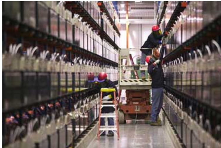
Figura 3.6: BESS de NiCd en Fairbanks, Alaska.
