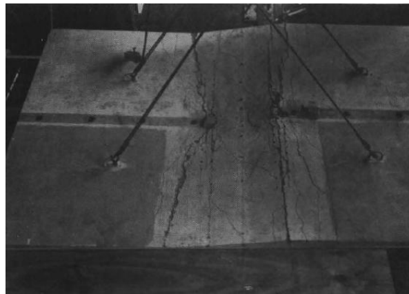
Figura 4-8 Foto de grietas en la losa ensayada [16].
