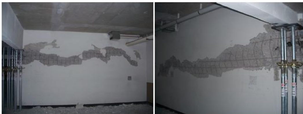
Figura 1-1 Daño en muros edificio en Macul – Santiago [13].
