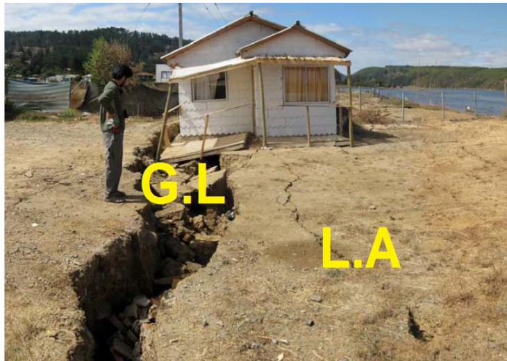
Figura N° 28: Licuefacción producida por el 27-F en superficie de rellenos antrópicos
