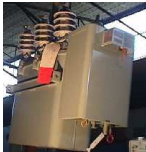
Figura 12: Dispositivo de protección Seccionalizador.
