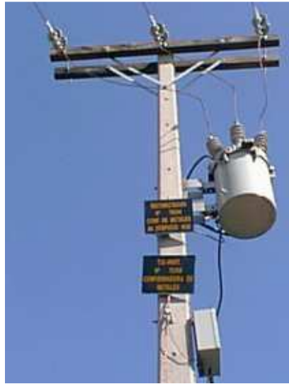
Figura 8: Dispositivo de protección Reconectador, Fuente [6].
