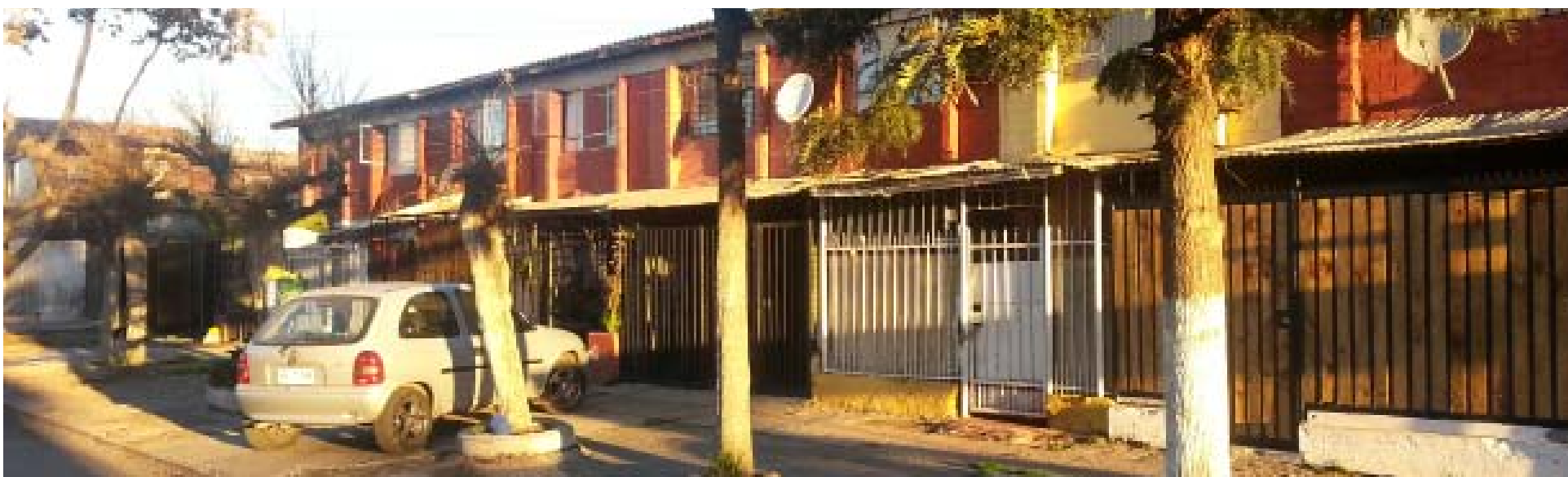
Fig 80: Vista de los cobertizos de la fachada Oriente de la cuadra de análisis, en donde se observa la materialidad: Planchas de Zinc sobre estructuras metálicas. Fuente: Archivo personal, Sebastián Román 2013
