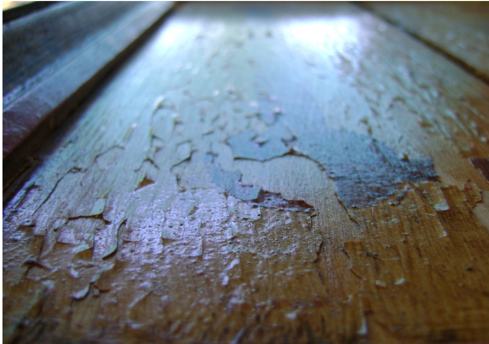
Imagen 18: Detalle levantamiento pintura y pérdida en zócalo ZMS20/6
