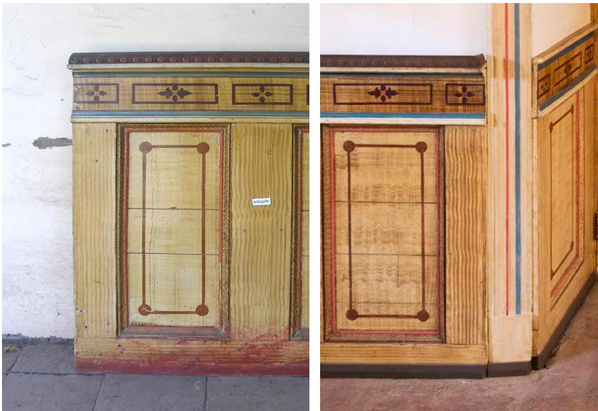
Imagen 84 y 85: fotografía 84 grafica la necesidad de un elemento protector para la zona inferior de los zócalos y la fotografía 85 exhibe la solución que se dio con los guardapolvos instalados.
