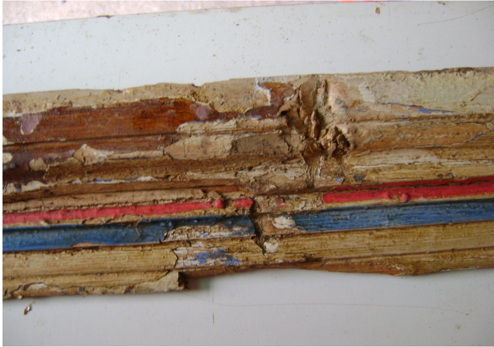
Imagen 24: Detalle daños pilastra NMH4
