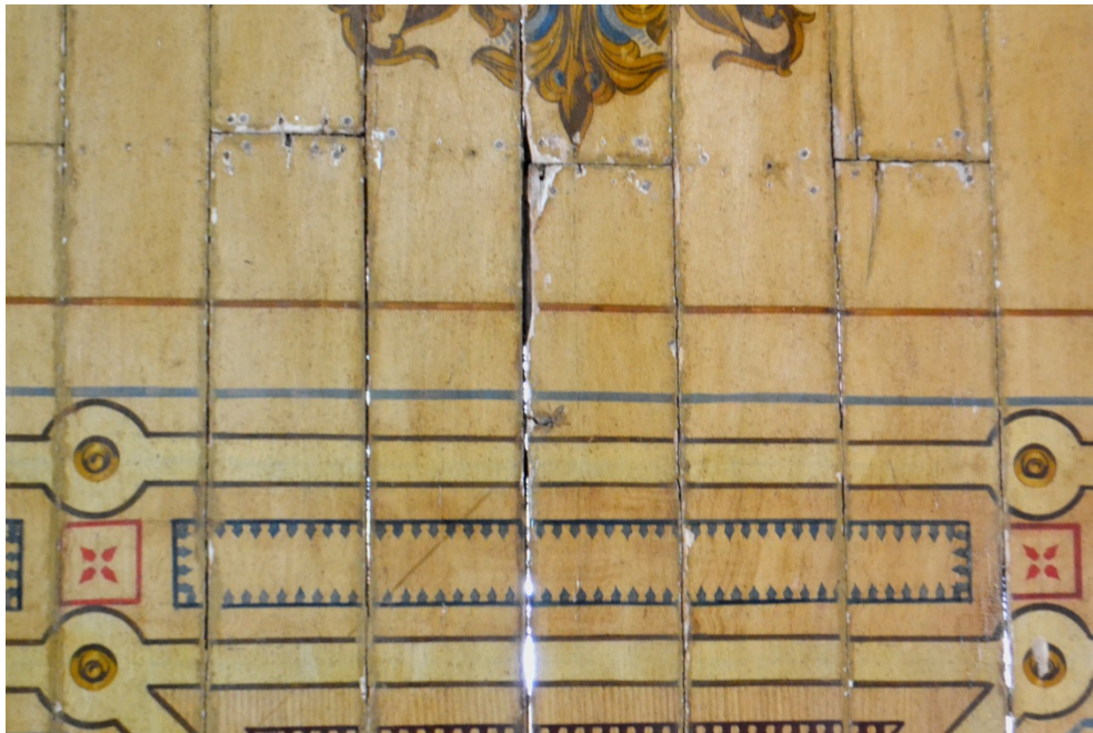
Imagen 34: detalle desprendimiento de astilla
