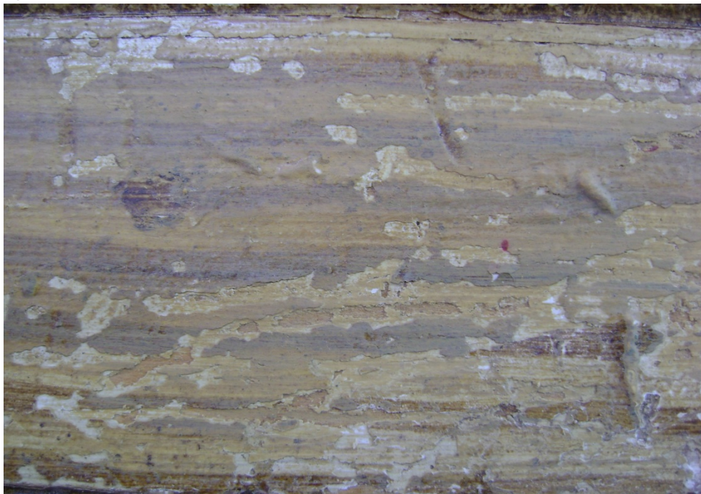
Imagen 29: Detalle repinte sobre pérdida y policromía en puerta PV31
