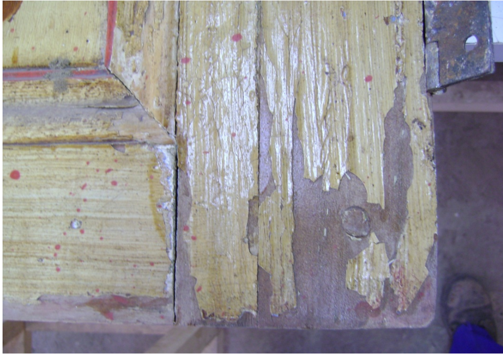
Imagen 28: Detalle pérdida capa pictórica en puerta PV32
