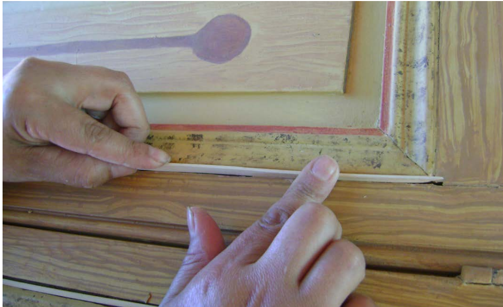
Imagen 69: injerto de álamo en pérdida de masilla original
