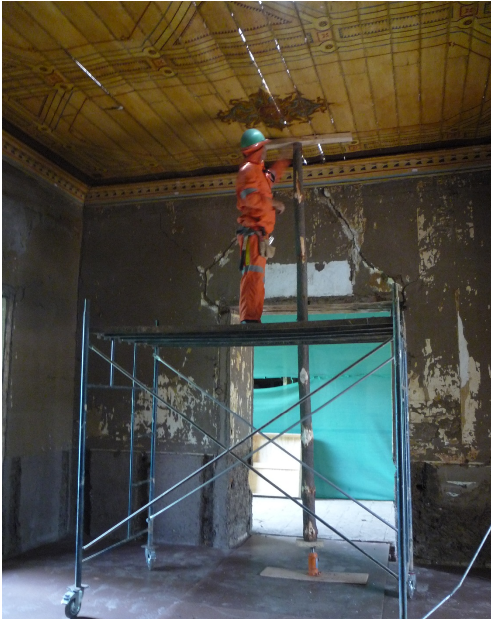
Imagen 86: carpintero nivelando el cielo para poder fijar la tablas contra las vigas superiores
