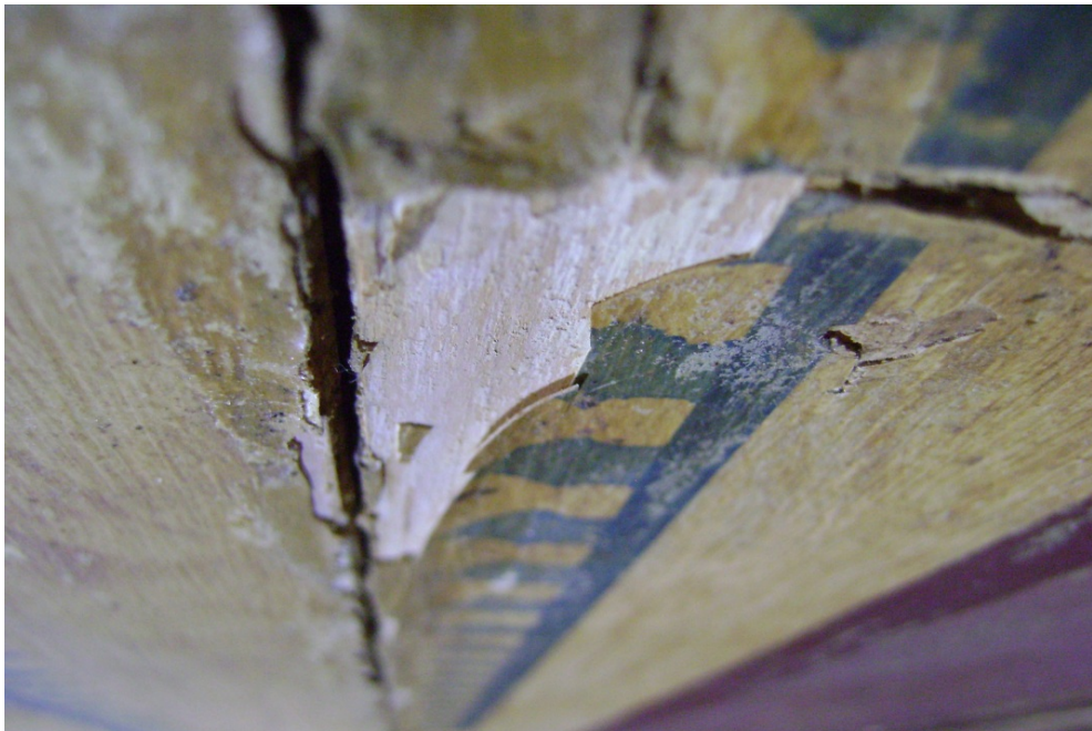
Imagen 38: detalle levantamiento capa pictórica en tablas cielo
