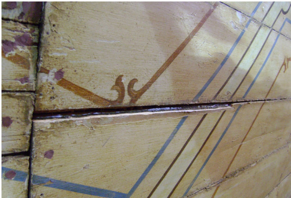
Imagen 95: detalle pérdida de astilla de madera en zona machihembrado
