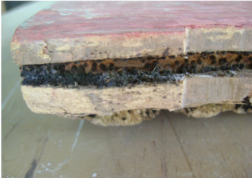
Imagen 23: Detalle hongos reverso zócalo lateral ventana 18
