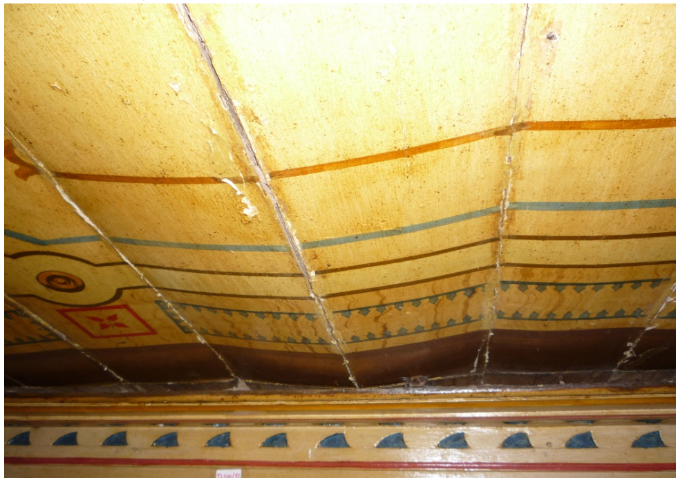
Imagen 31: pérdida de nivel en tablas cielo
