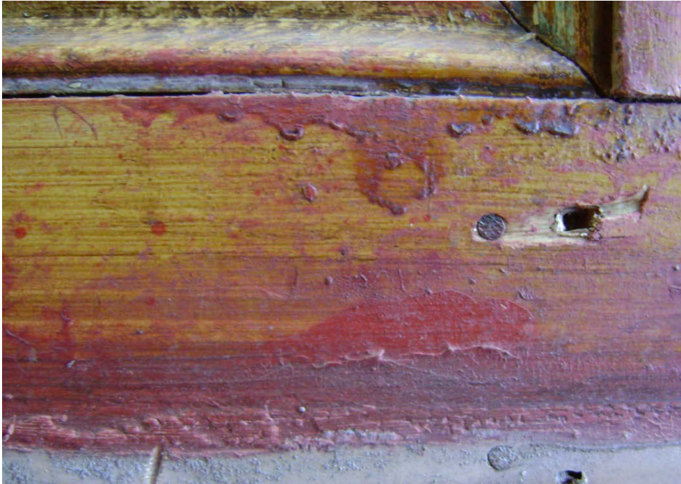
Imagen 17: Detalle manchas de cera en zócalo ZMS20/8
