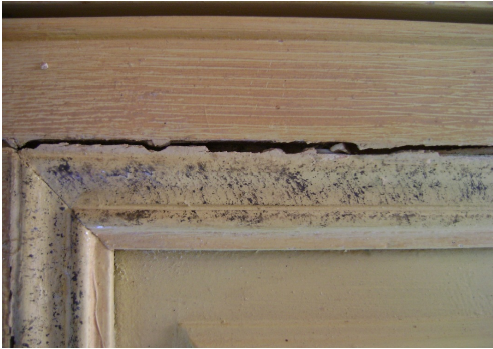
Imagen 25: Detalle perdida de masilla en postigo ventana V20
