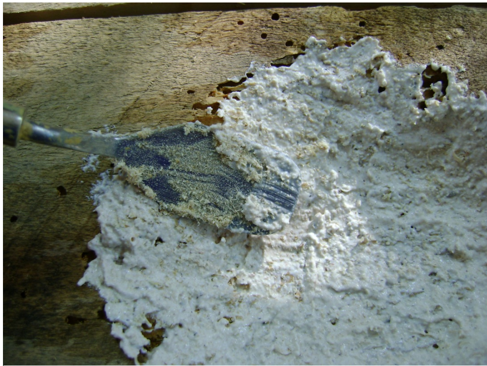
Imagen 59: resane de faltante carcomido por ataque de xilófagos con pasta de aserrín con cola
