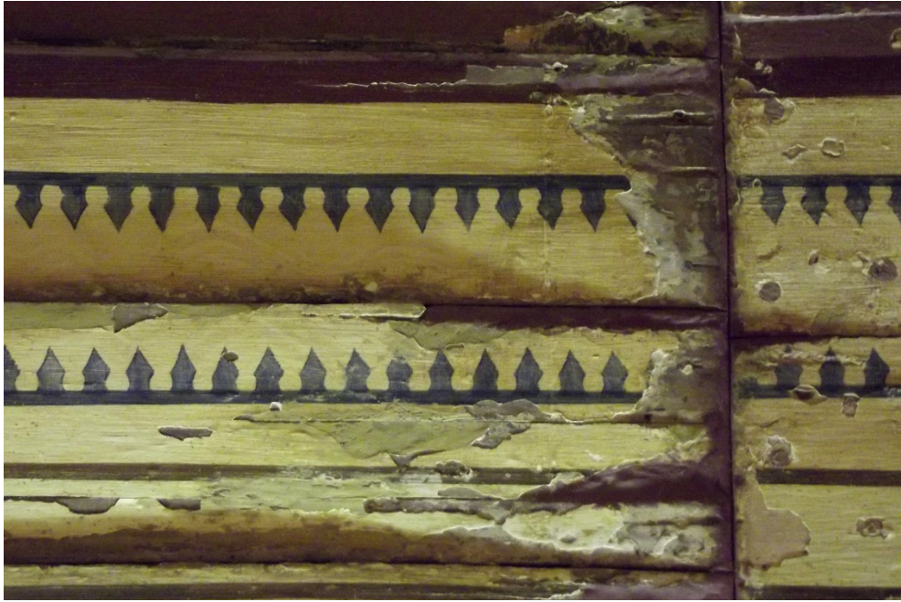
Imagen 37: detalle pérdida capa pictórica en unión cambio de cielo
