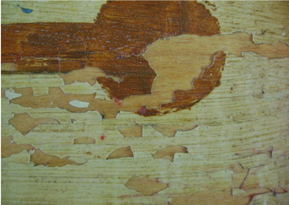
Imagen 19: Detalle pérdida capa pictórica en zócalo ZMS20/6
