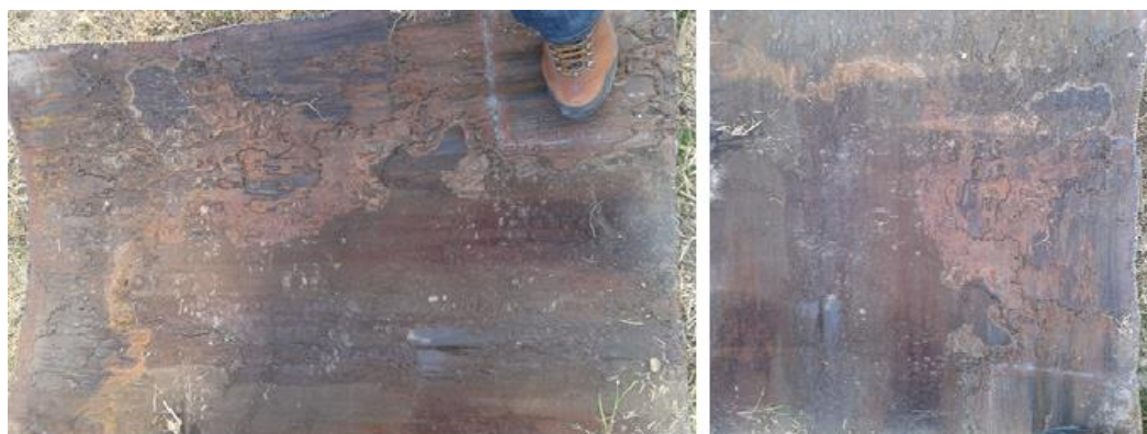
Figura 9: Corrosión en la torre separadora luego de 15 años de operación.
