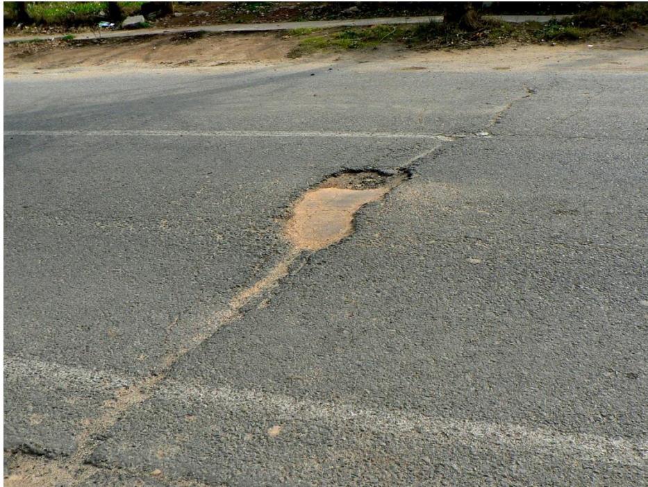
Anexo H 5: Punto 39. Grieta.
