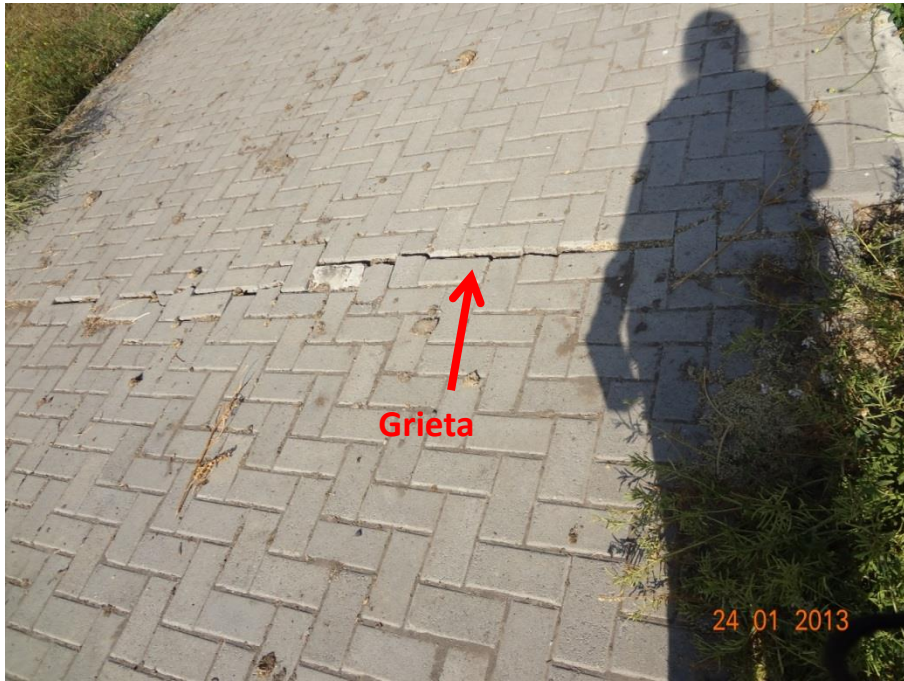
Anexo H 13: Punto 64. Leve grieta en terreno.
