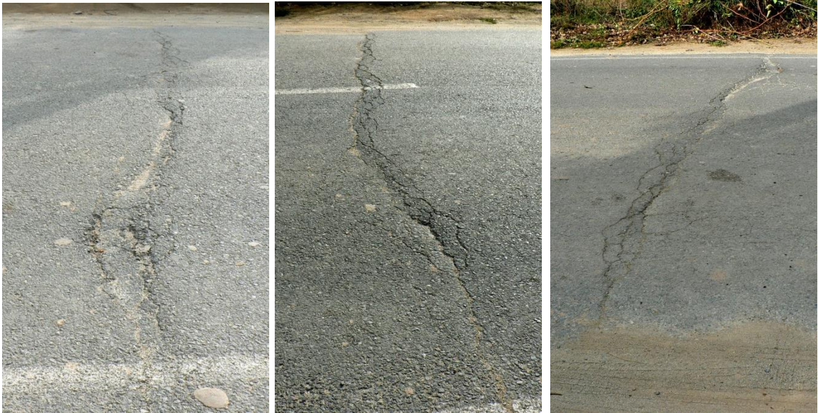
Anexo H 6: Punto 40. Grietas.
