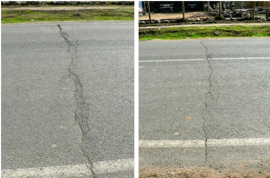
Anexo H 2: Puntos 35 y 36. Grietas.
