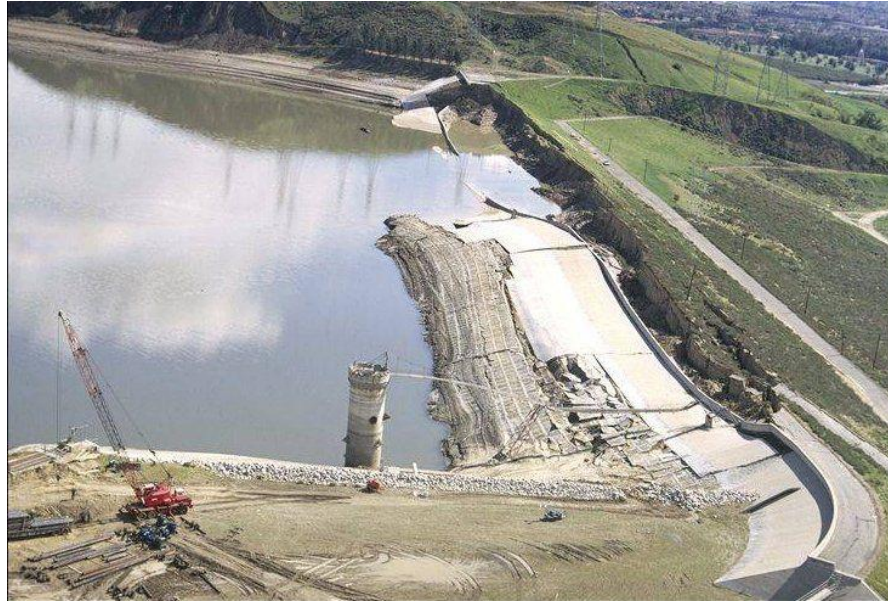
Figura 18: Licuefacción en la Represa Lower San Francisco, producto del terremoto de magnitud 6,7 de 1971, en San Fernando, EEUU.
