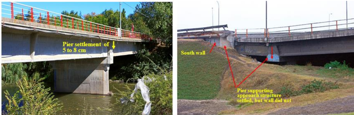
Figura 17: A la izquierda: Asentamiento del pilar central del Puente San Nicolás en la región del Bio Bio, Chile. A la derecha: Asentamiento del Puente Juan Pablo II, Concepción, Chile. En ambos casos el fenómeno se produjo posterior al terremoto del 27 de Febrero de 2010.
