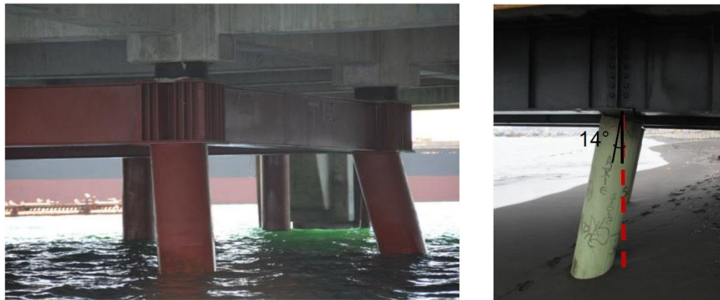
Figura 20: Inclinación de pilotes en uno de los muelles del Puerto de Coronel, Chile, Producto del terremoto del 27 de Febrero. González, 2012, en VII congreso Chileno de Geotecnia.
