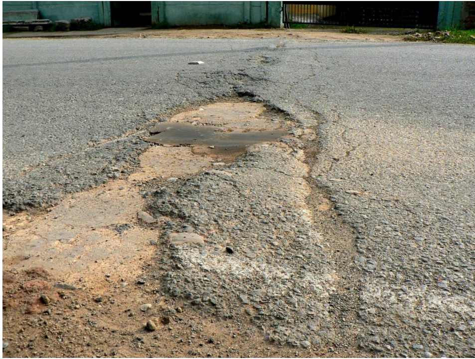
Anexo H 3: Punto 37. Grieta.
