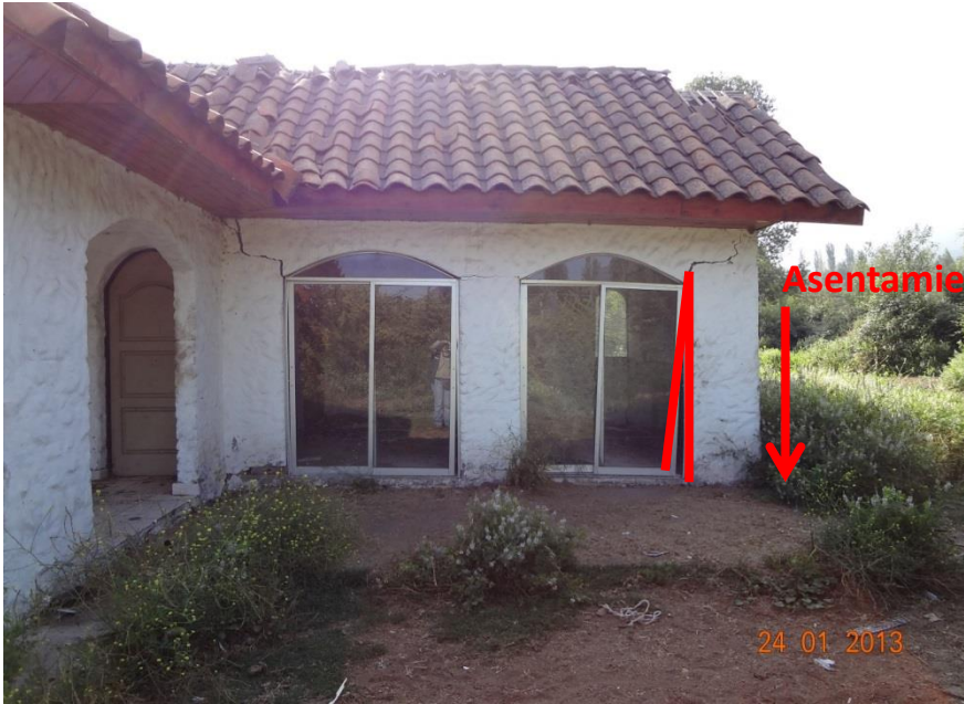
Anexo H 10: Punto 64. Casa donde se observan grietas y asentamientos diferenciales
