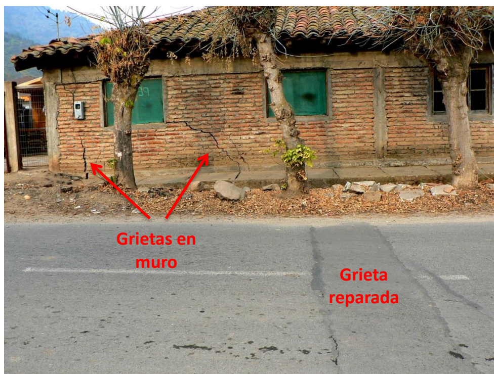
Anexo H 7: Punto 41. Grietas en camino y daños estructurales en viviendas.
