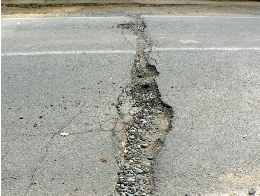
Anexo H 1: Punto 33. Grieta en medio del camino. Orientación N125E. 10 a 20 cm de ancho, levantó el lado norte alrededor de 5 cm sobre el lado sur.
