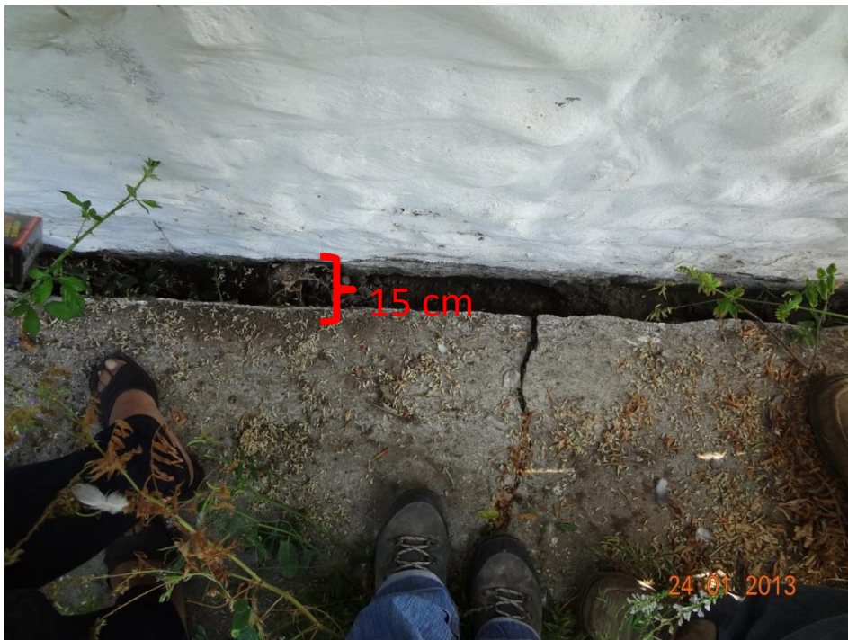
Anexo H 12: Punto 64. Separación entre pared y borde encementado
