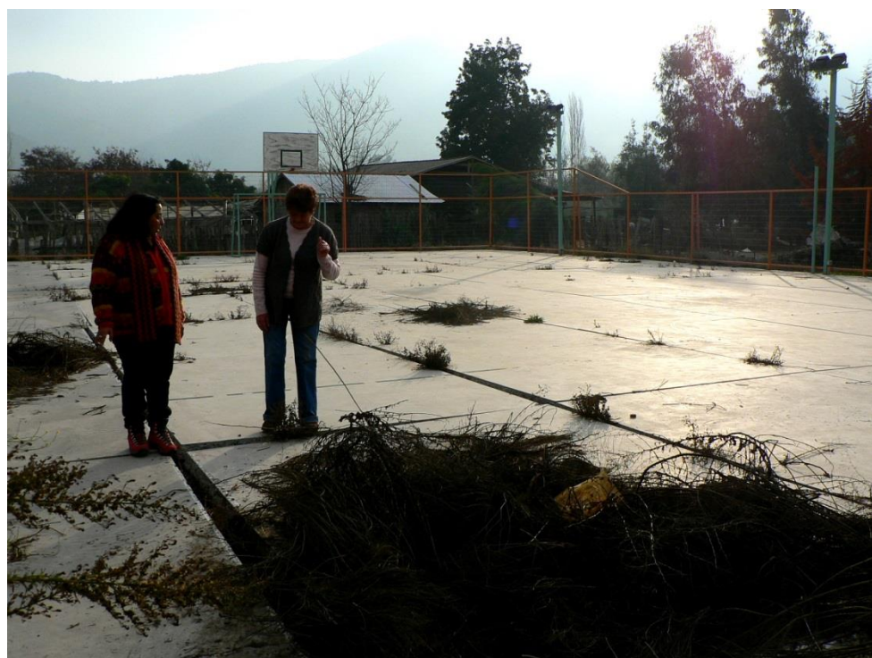
Anexo H 8: Separación de bloques y grietas en multicancha.
