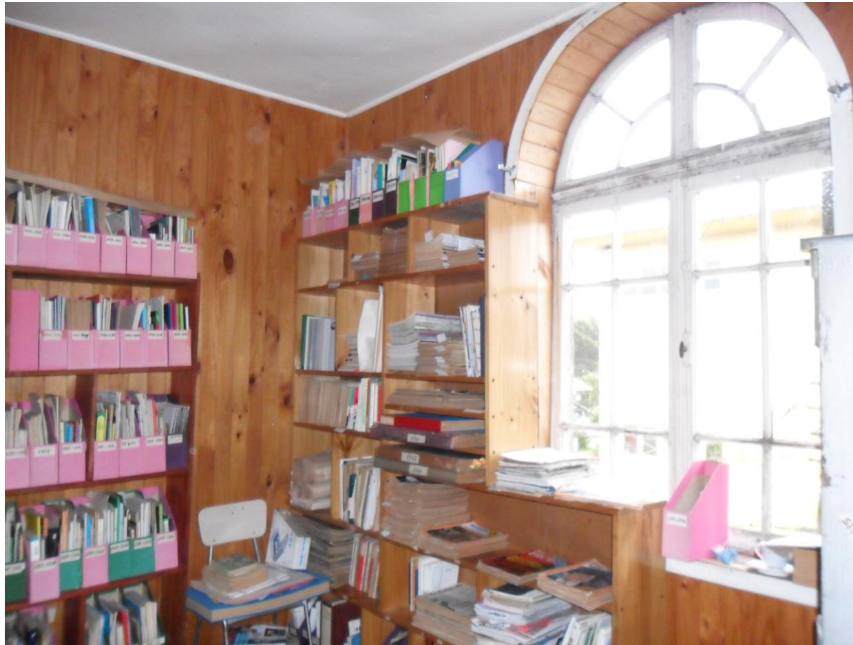
Imagen n° 9: “Estanterías de sala n° 1 ubicada en segundo piso”. Existe una ventana que da al frontis de Ramírez n°247.Observamos ausencia de tecnologías de conservación del material y de cortinas que puedan proteger del sol y la humedad. Fotografía tomada por la autora en mayo de 2011.
