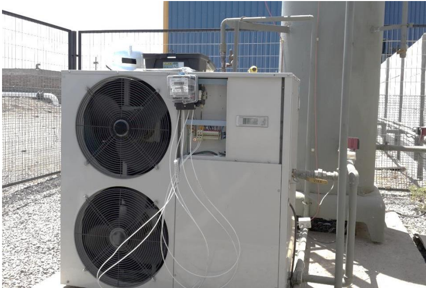
Figura 25: Instalación de remarcador de energía activa para medición de COP en bomba de calor
