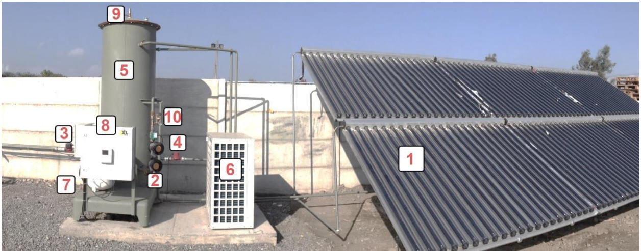
Figura 9: Disposición real de los equipos en la planta.
