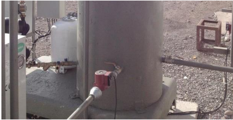
Figura 16: Bomba Grundfos 32-70 180 en circuito de alimentación a bomba de calor
