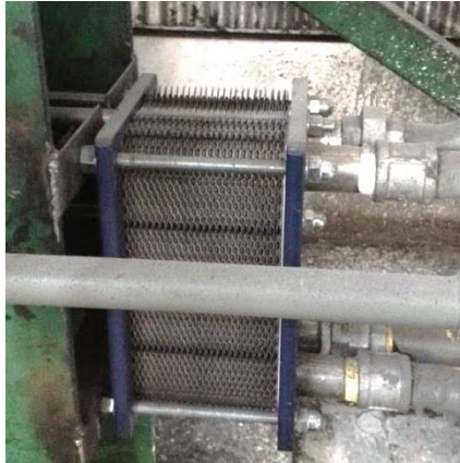
Figura 13: Intercambiador de calor Anwo instalado en planta
