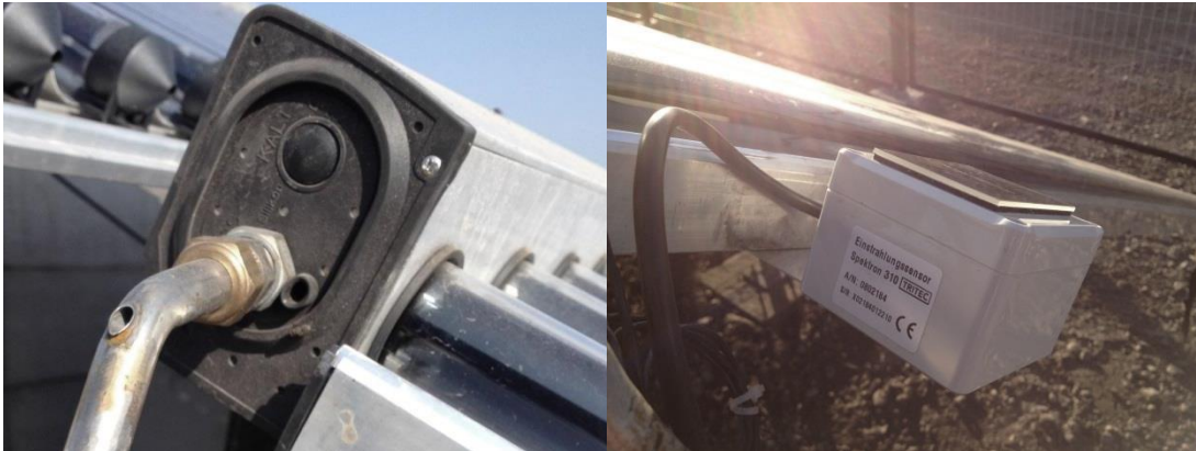
Figura 20: Salida del panel solar con orificio para insertar termocupla en vaina (izquierda) y piranómetro (derecha)
