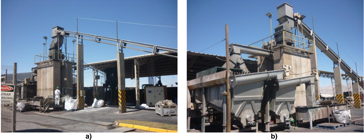
Figura 4.2: Planta de Baterías: a) Vista del elevador de baterías, b) Separador de material ligero
