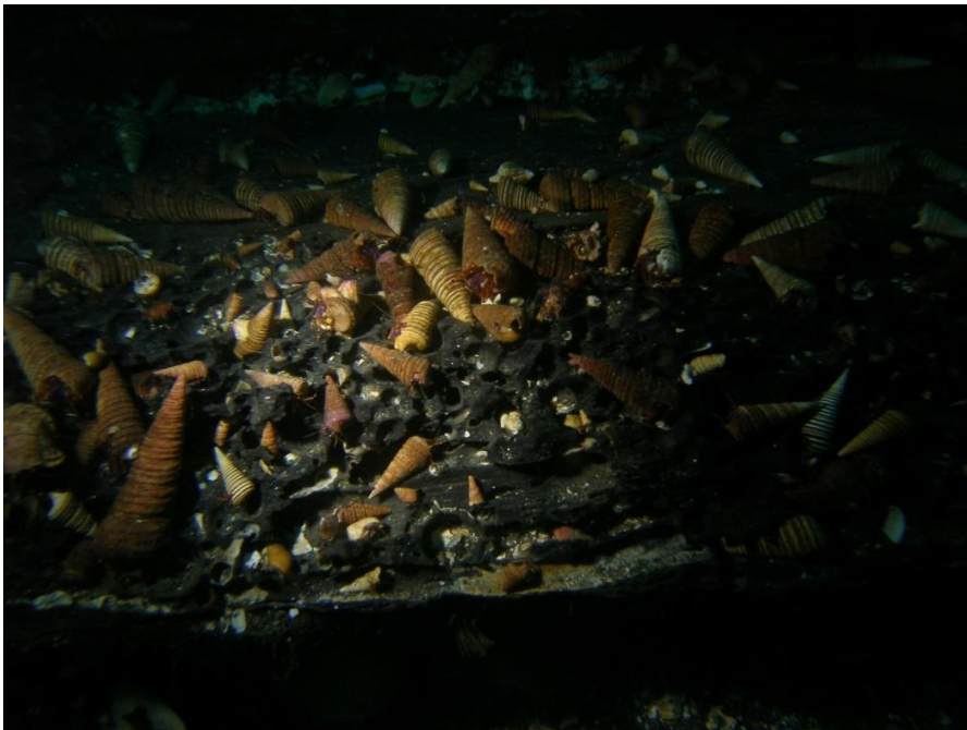
Figura N°21. Ataque provocado por la acción del molusco Teredinidae y Xylophaga en parte de la estructura principal.
