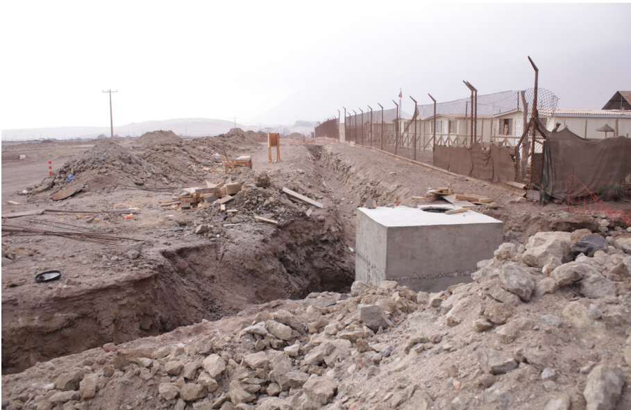
IMAGEN 59 > ACTUAL CONSTRUCCIÓN DE ALCANTARILLADO PARA LA NUEVA ZONA URBANA LOS VERDES. FUENTE: ELABORACIÓN PROPIA
