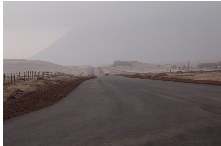
IMAGEN 60 > ACTUAL CONSTRUCCIÓN DEL NUEVO TRAZADO CONCESIONADO RUTA A-1 IQUIQUE-AEROPUERTO FUENTE: ELABORACIÓN PROPIA
