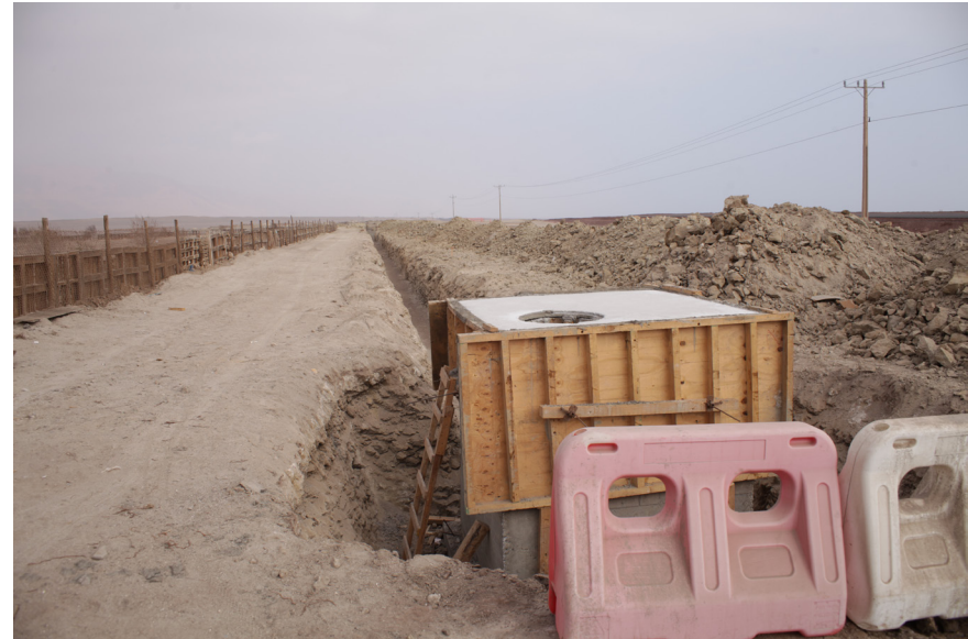
IMAGEN 58 > ACTUAL CONSTRUCCIÓN DE ALCANTARILLADO PARA LA NUEVA ZONA URBANA LOS VERDES. FUENTE: ELABORACIÓN PROPIA
