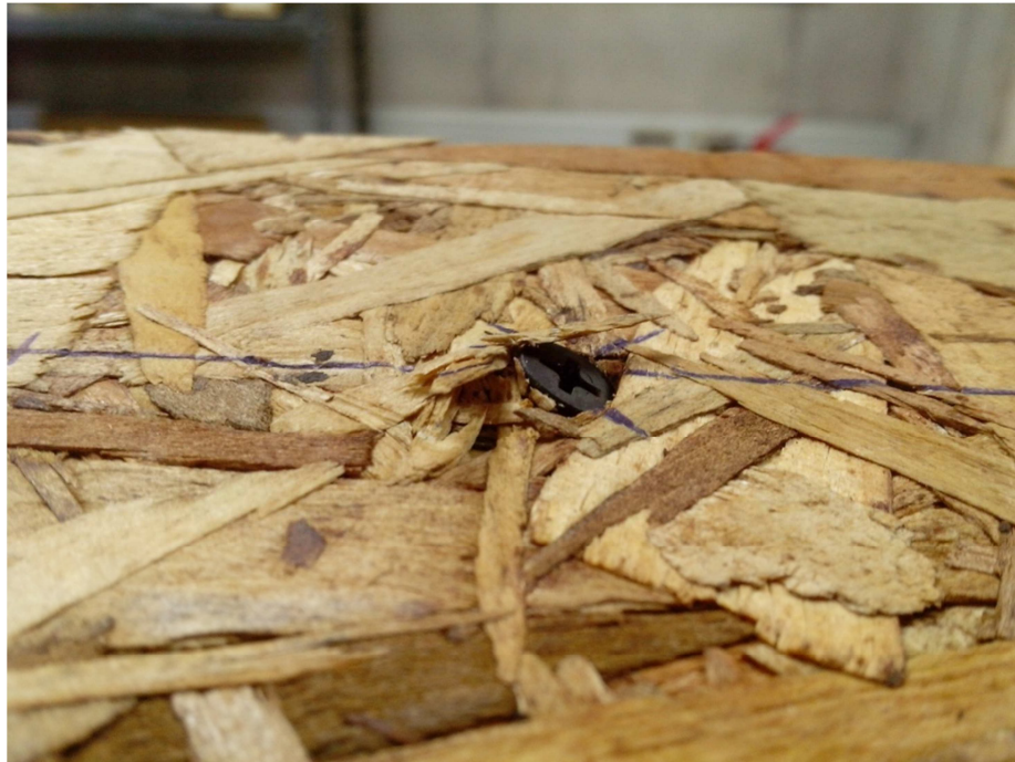
Figura 3.18: Modo de falla observado en los tornillos
