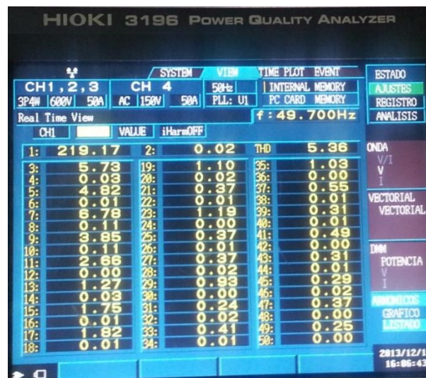
Figura 3-3: Tensión, frecuencia y distorsión armónica durante pruebas de implementación de algoritmos en Central Micro Hidráulica Plug & Play en estado stand-by.
