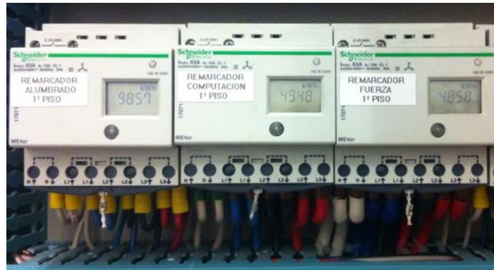
Figura 4-3: Remarcadores de consumo eléctrico
