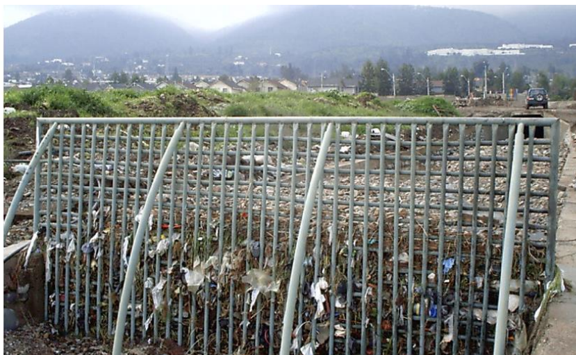
COLAPSO DEL SISTEMA DE CANALIZACIÓN AGOSTO 2005
