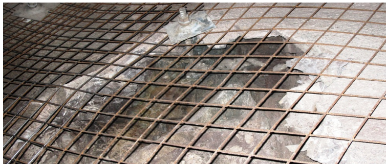
Figura 3.21: Detalle Colapso Shotcrete.
