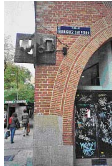
Fig. 31. Intervención no restaurativa, por meteorización del zócalo de ladrillo en esquina principal del edificio, frente de calle Rodríguez San Pedro (bajo placa conmemorativa de la residencia de Pablo Neruda). Foto. M.I.P., 2006 ©
