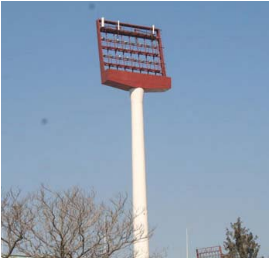
50. Torres de iluminación actualmente
