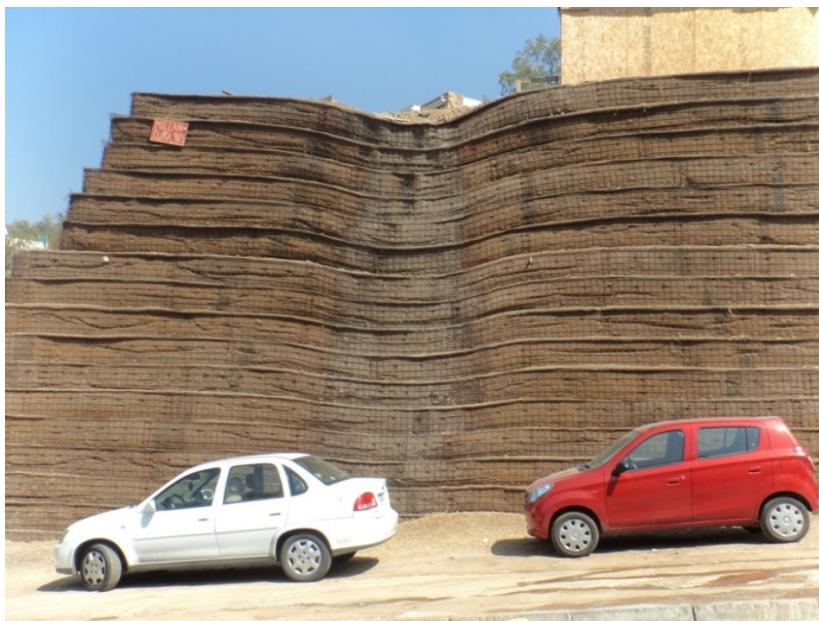
Figura 4.36. Corte artificial de ladera con malla de refuerzo, se observa deformación por infiltración de agua proveniente de la construcción por sobre el corte.
