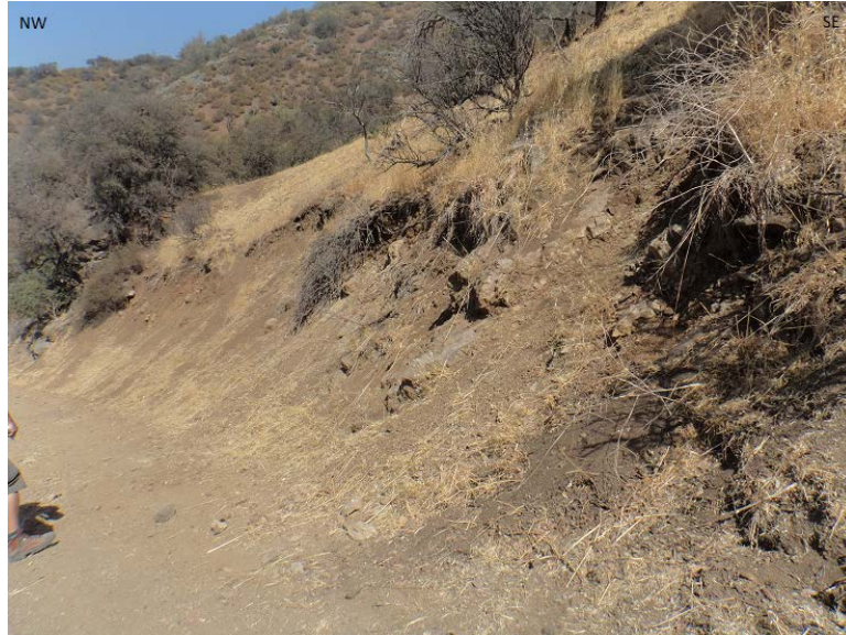
Figura 4.18. Depósitos coluviales y de caída de roca en talud artificial a lo largo de la quebrada.
