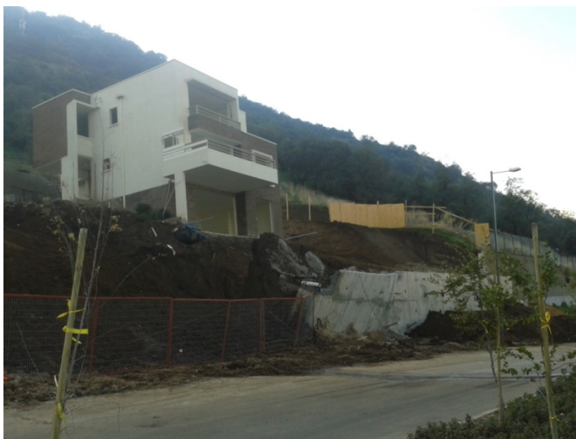
Figura 4.27. Fotografía muestra la unidad de suelo de relleno en la fundación de una de las casas construidas en la zona de estudio, se observa rasgos de deslizamiento de suelo.
