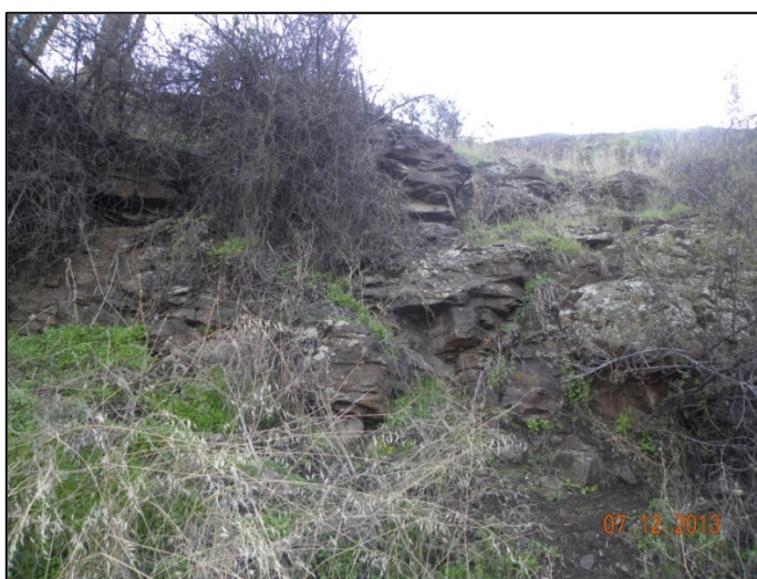
Figura 4.9. Areniscas estratificadas de disposición subhorizontal. asignadas a la Formación Abanico hacia el este de la quebrada de Los Chanchos.
