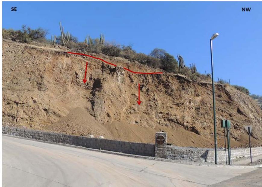
Figura 4.21. Rasgos de deslizamiento superficial de suelo (roca muy meteorizada) en talud artificial hacia el este de la quebrada de Los Chanchos.
