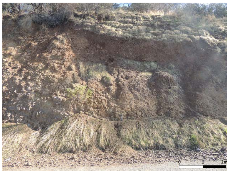
Figura 4.23. Deslizamiento superficial de suelo en el área de estudio.
