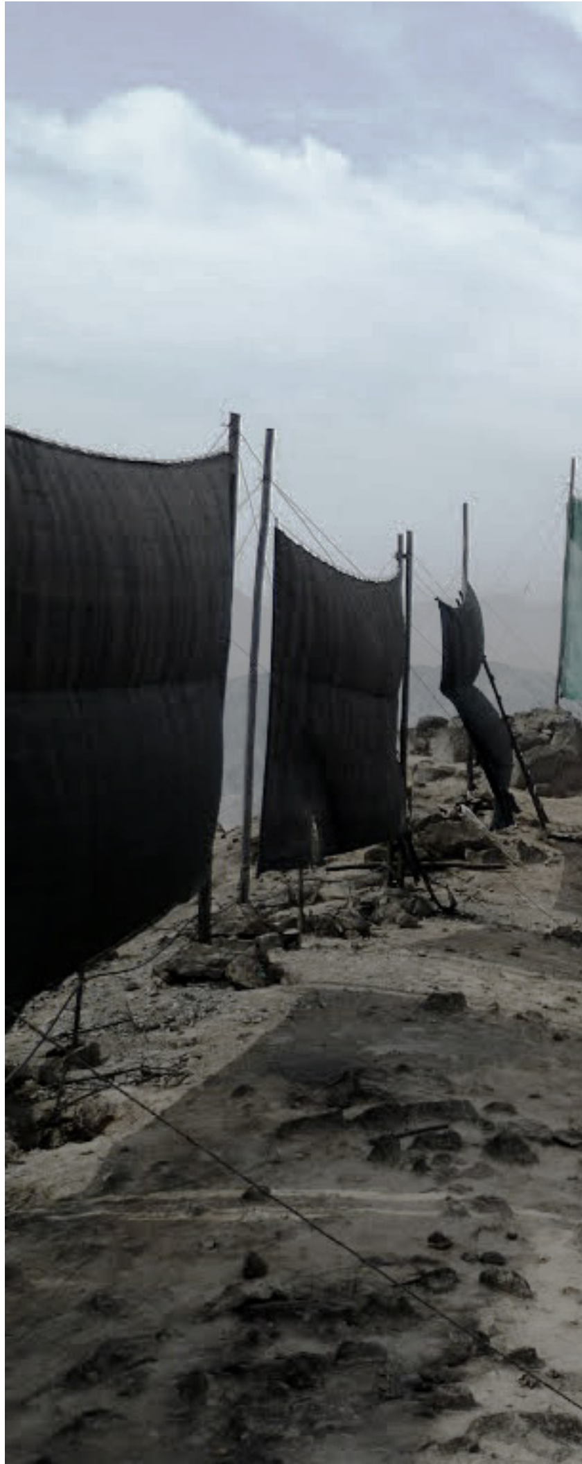
Imagen 22. Atrapanieblas dañados por el viento en Perú: rotura de mallas y estructura deficiente. Fuente: FLICKR, 2014.
