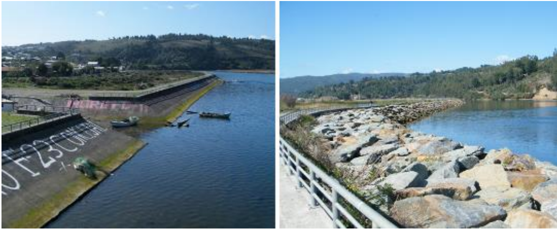
Imagen 41 / Obras de contención de marejadas en el borde costero de Tirúa / Fuente: archivo propio
