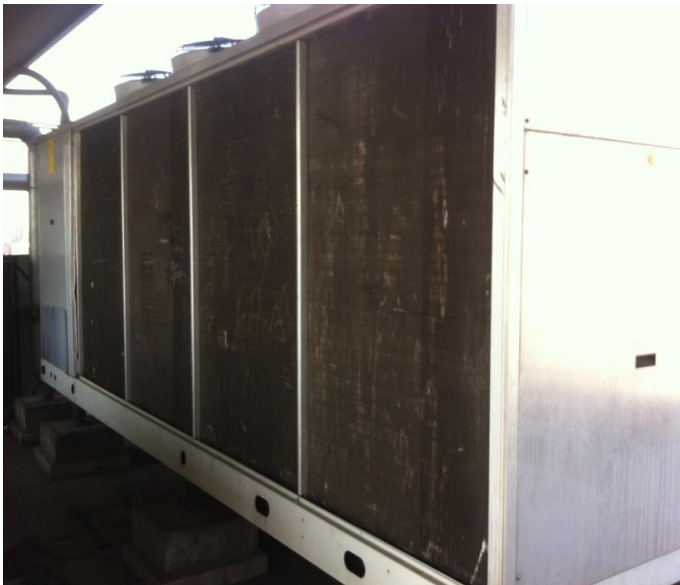
Ilustración 20 Fotografía equipo chiller Zona 6.
