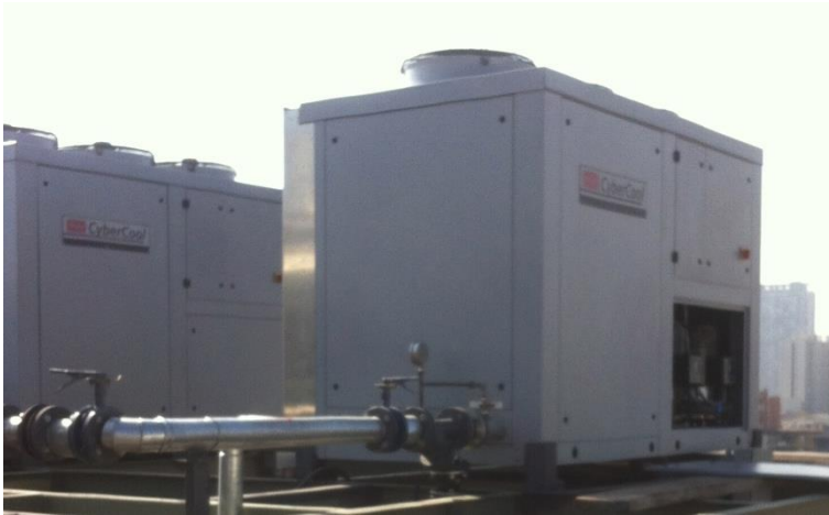
Ilustración 24 Fotografía Chiller Centro de datos, Zona 8.
