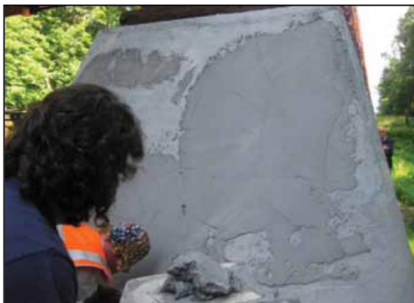
Figura 2.22: Pedestal a reparar
