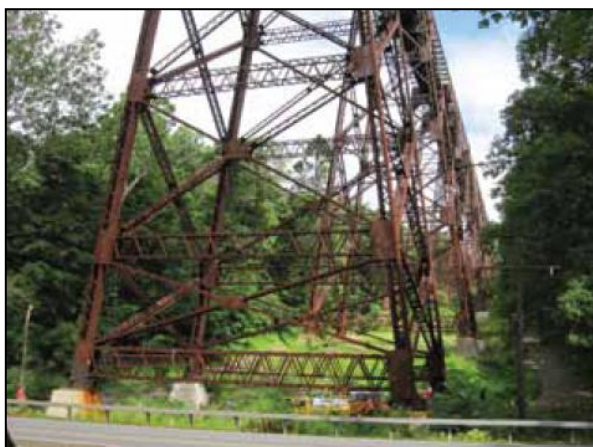
Figura 2.21: Puente a reparar en Nueva York
