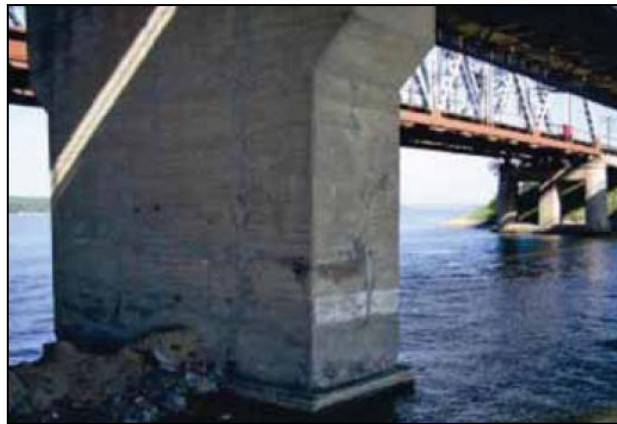
Figura 2.18: Grietas en los pilares del muelle
