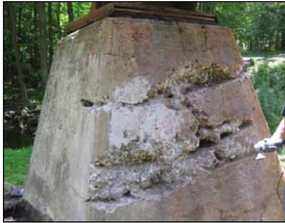
Figura 2.23: Agrietamiento y desprendimiento del hormigón de los pedestales del puente
