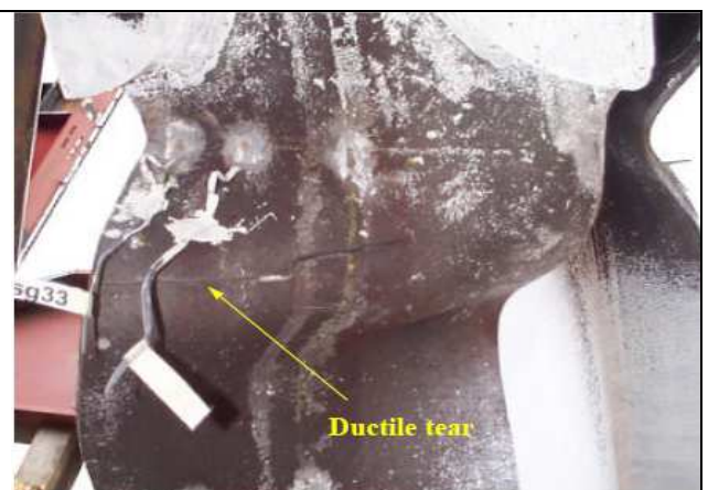
Figura 2.40: Grieta dúctil en ala superior (SAC Steel Project, 2014).
