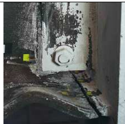
Figura 2.44: Fractura del ala inferior (SAC Steel Project, 2014).
