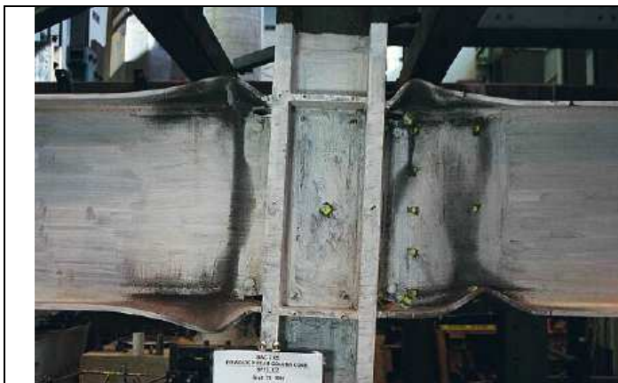
Figura 2.43: Fractura en el ala y en la soldadura del alma (SAC Steel Project, 2014).
