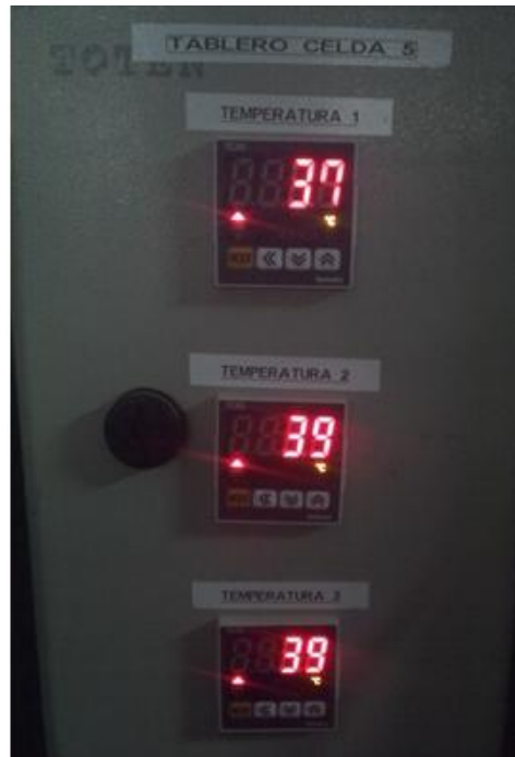
Figura 26. Tablero electrónico con temperaturas registradas por cada una de las termocuplas dispuestas a diferentes alturas en el seno del lecho mineral.
